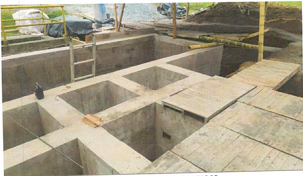
TANQUE FLOCULADOR Y SEDIMENTADOR
