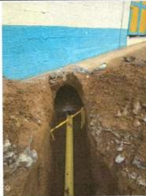
1.16 Instalacion tuberia corrugada PVC-S de 315 mm (12"), incluye manejo de aguas en zanja.
