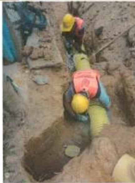
4.23 Instalacion tuberia corrugada PVC-S de 160 mm (6"), incluye manejo de aguas en zanja.
