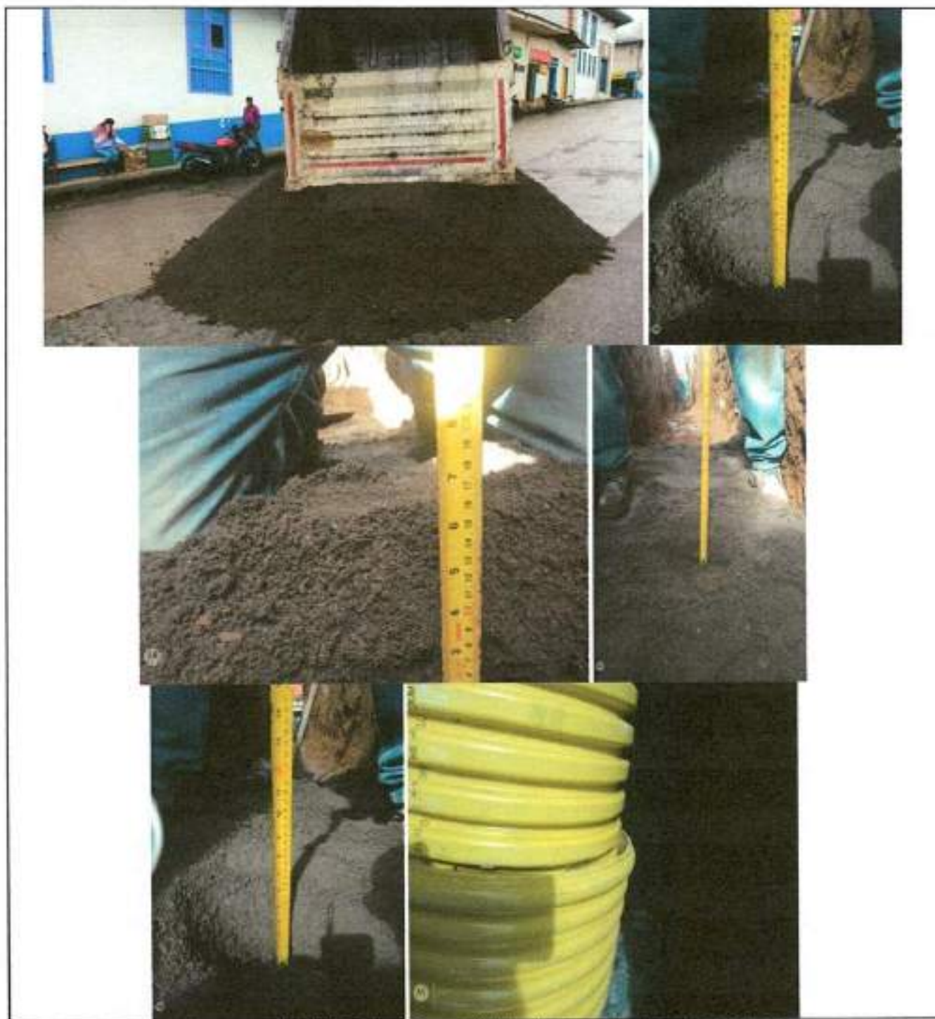
1.15 Instalacion tuberia corrugada PVC-S de 160 mm (6"), incluye manejo de aguas en zanja.
