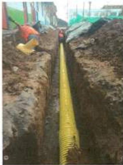
1.15 Instalacion tuberia corrugada PVC-S de 160 mm (6"), incluye manejo de aguas en zanja.
