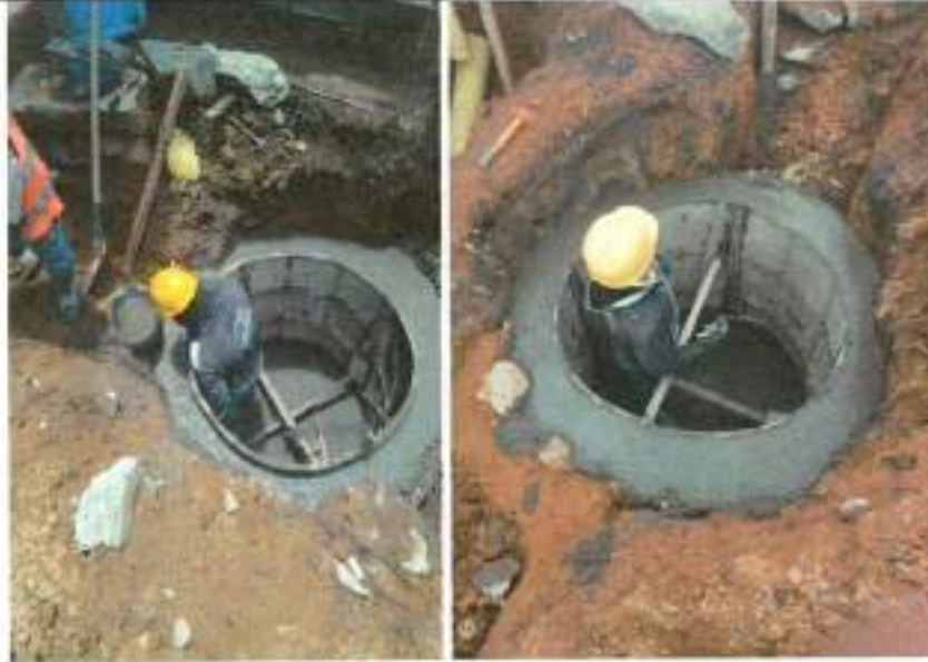
4.12 Suministro e instalación de tapa con aro pozo de inspección en HF D=0.60cm para tráfico pesado con logo y araña de refuerzo
