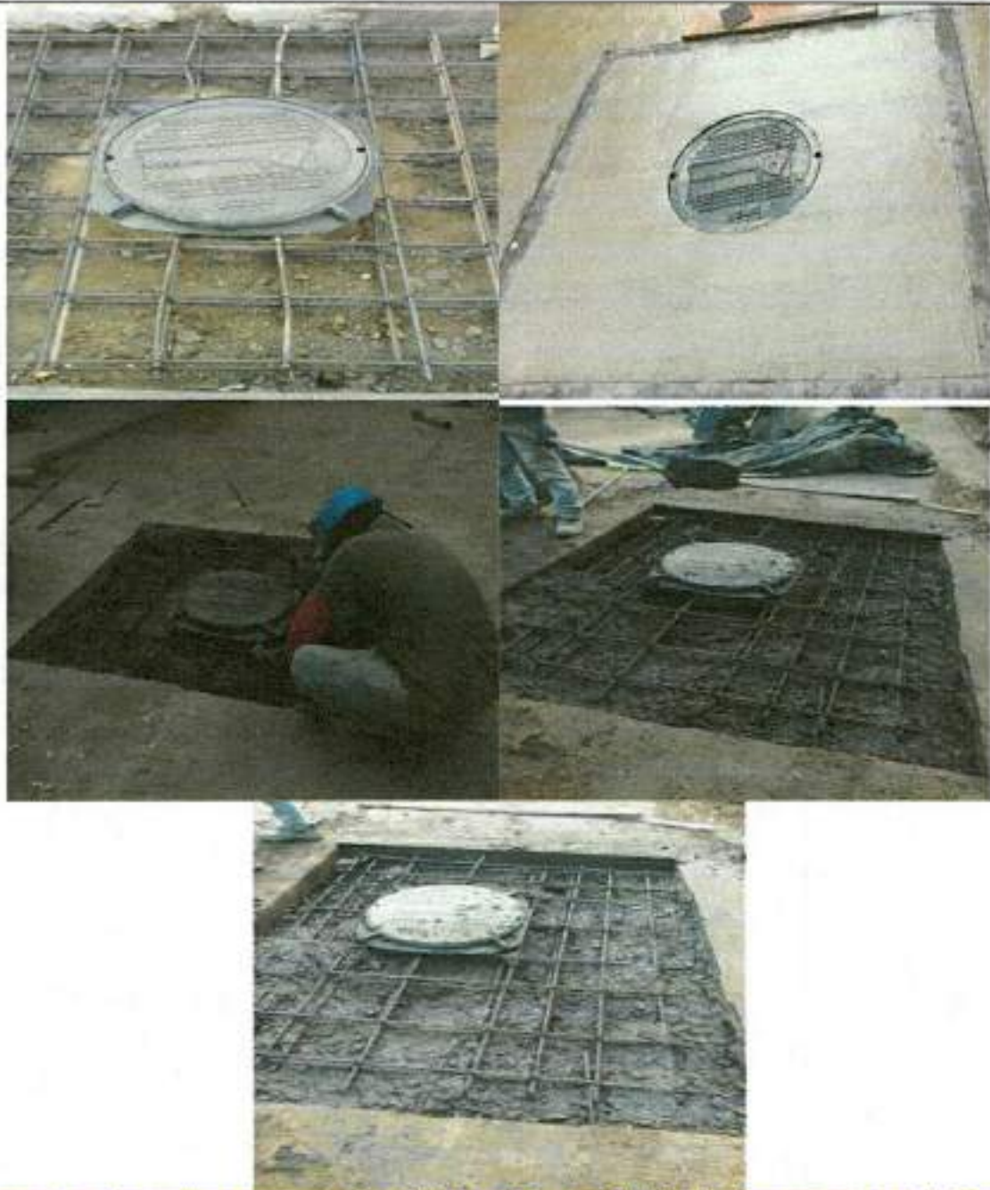
2.29 Acero de refuerzo (Item contractual ya fijado en el frente 4, ITEM 4.19), presupuesto oficial.
