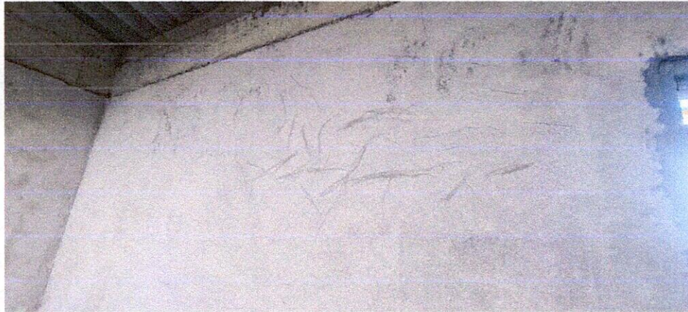
Imagen 6: Revisión general de pañetes internos en los laboratorios y oficina, se solicita al contratista e inspector de obra revisar las fisuras en general y verificar la calidad del pañete al parecer por alteraciones en la mezcla que pueda terminar en desprendimientos del mismo, por ende se realiza curado de zonas afectadas para posterior aplicación de estuco plástico y vinilo epoxica.
