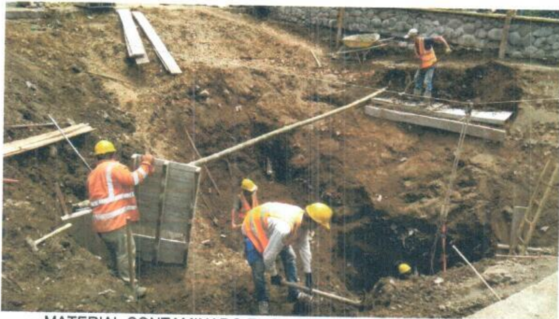
MATERIAL CONTAMINADO ENCONTRADO EN LA EXCAVACION
