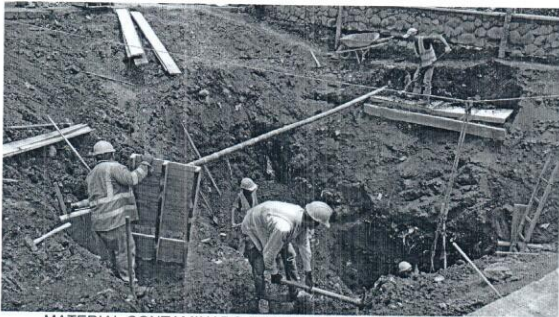
MATERIAL CONTAMINADO ENCONTRADO EN LA EXCAVACION
