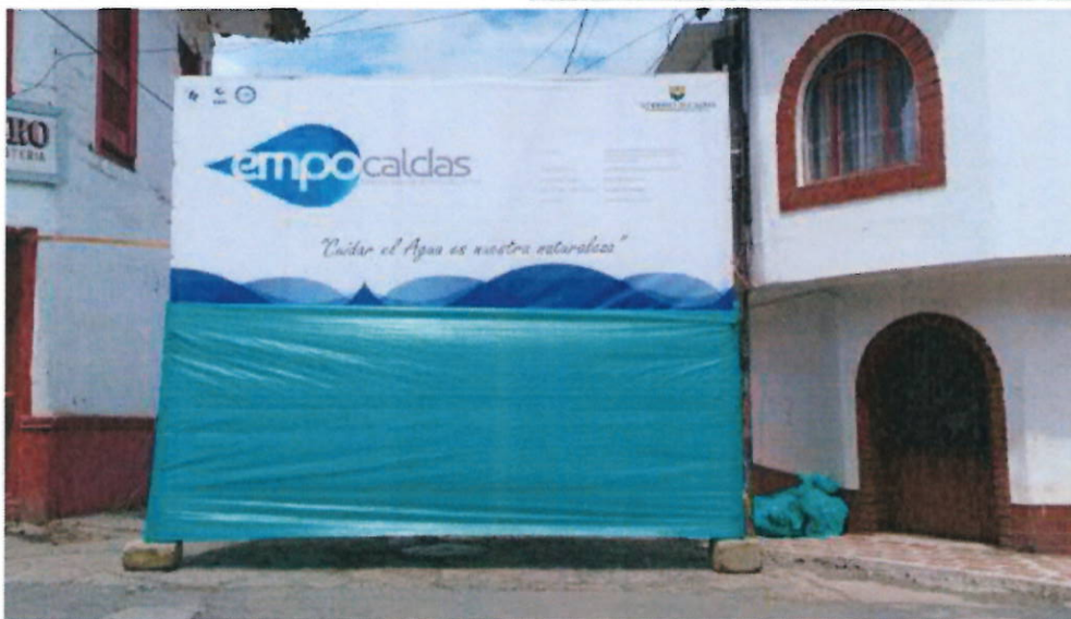
Figura 1: Estado de la calle 36 antes de ser intervenida - delimitaciones para corte de pavimento - vaya informativa Empocaldas
