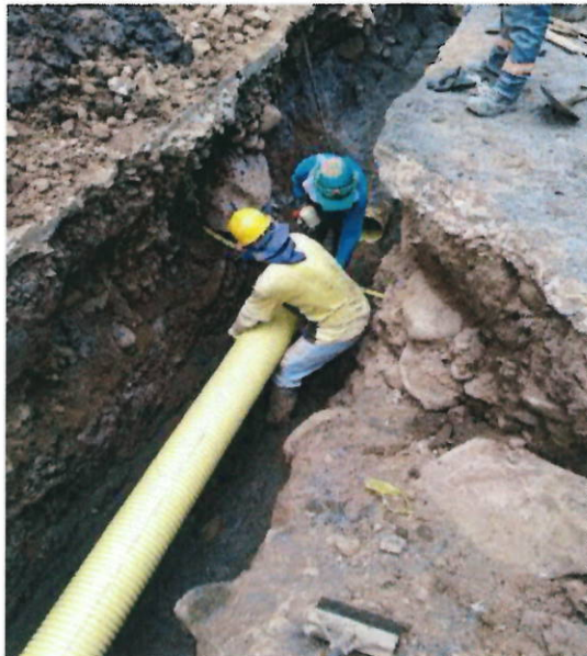
Figura 5: Instalación de la Tubería 10" en el eje central de la vía Calle 36
