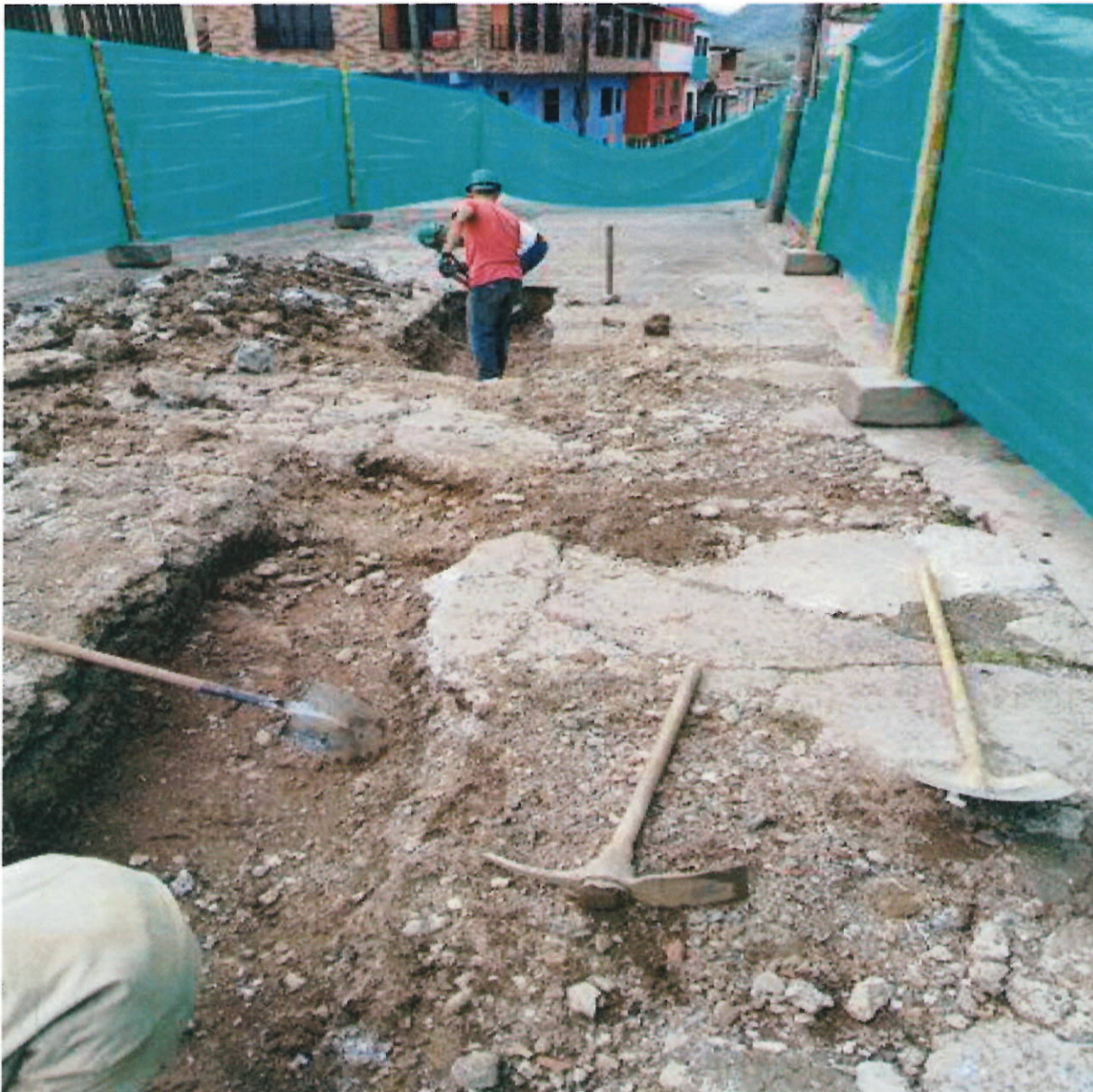
Figura 3: Demolición de la capa de rodadura por el eje central de la tubería principal
