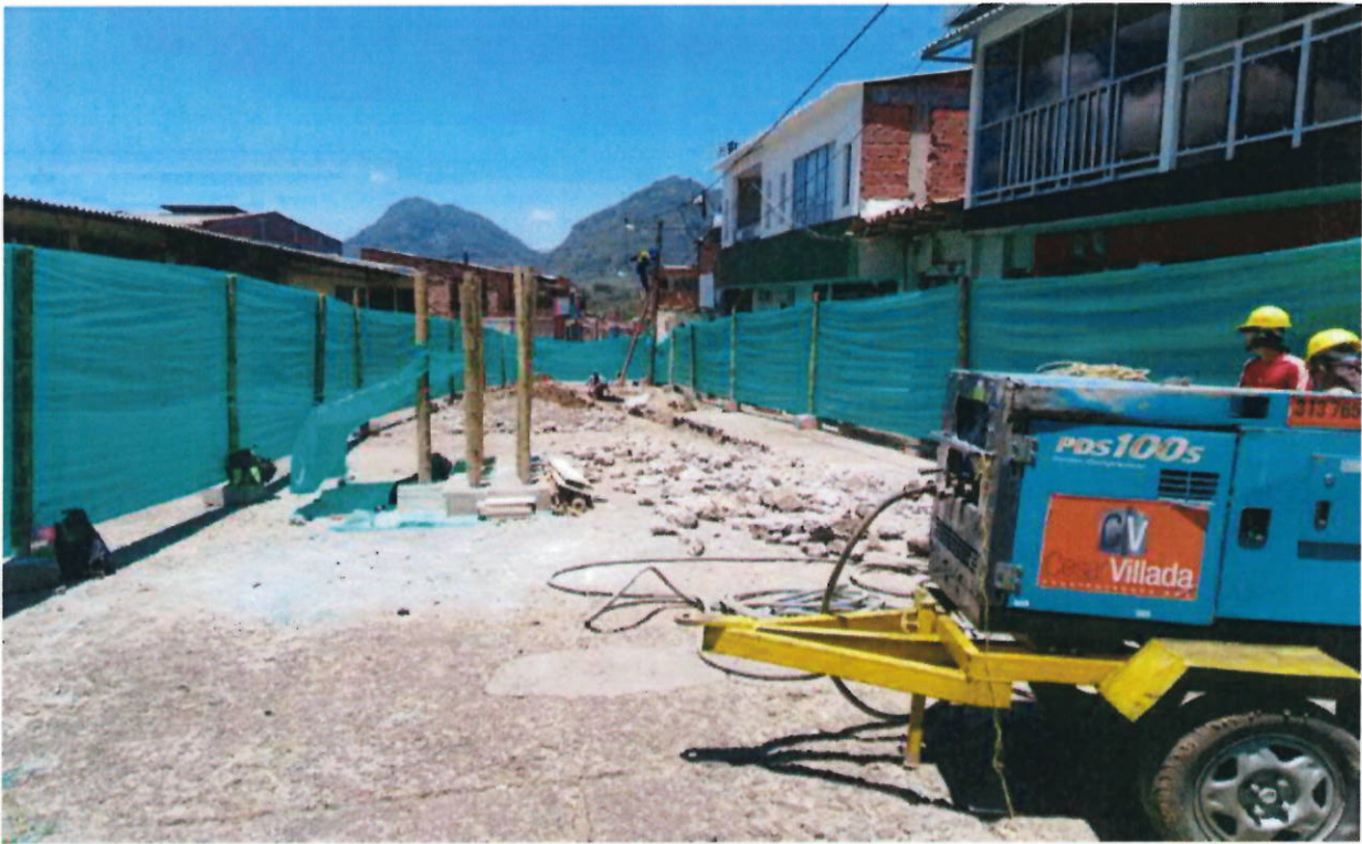
Figura 4: Demolición de la capa de rodadura por el eje central de la tubería existente
