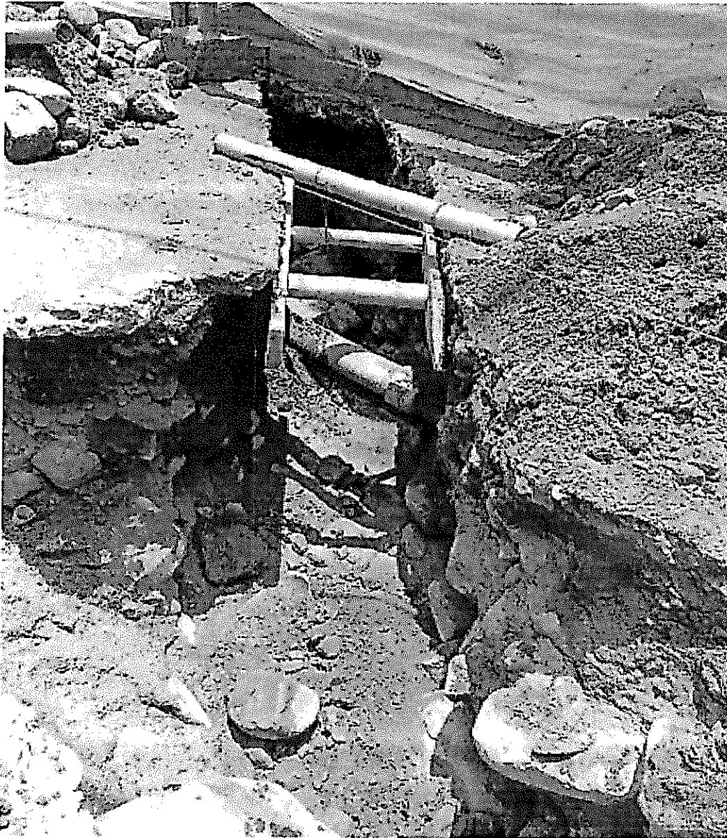
Figura 4: Sobre-excavación de de domiciliaria producida por desprendimientos de material conglomerado
