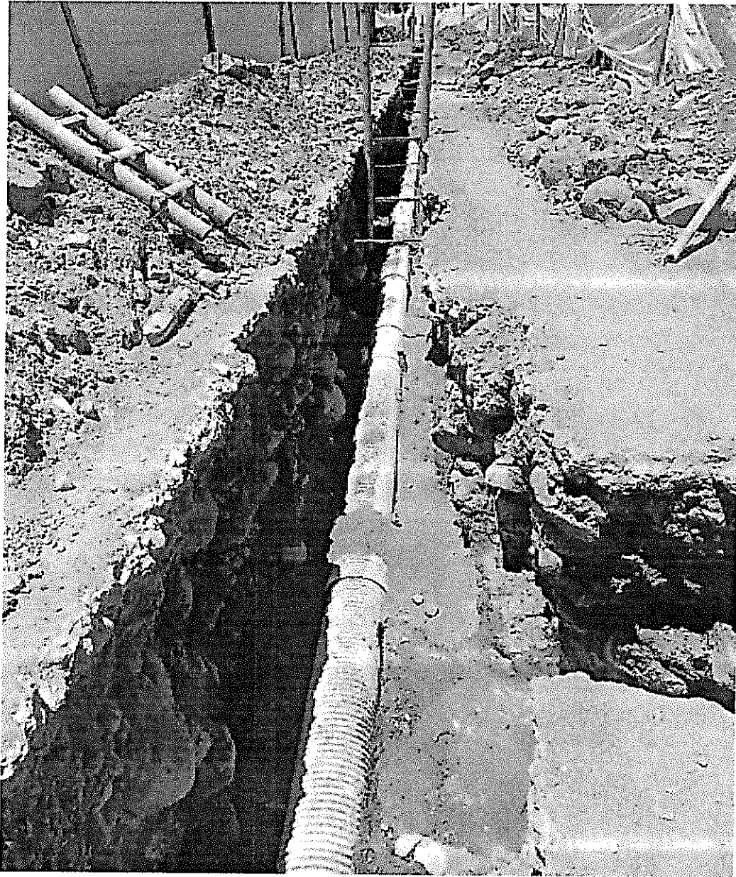
Figura 2: Tubería 12" instalada de esquina a esquina sobre la base de arena 0.05 m
