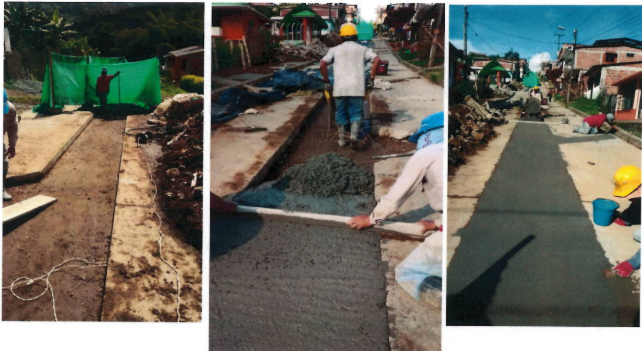
registro 2: construccion de domiciliarias, instalacion afirmado, toma densidades y vaciado de concreto.
