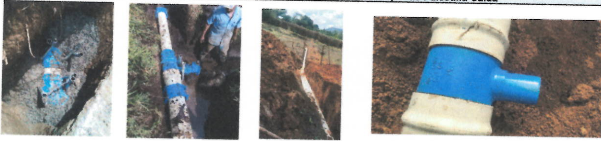
Reposición de alcantarillado en la calle 6 entre carreras 8 a la 9 en el municipio de Chinchina Caldas- Cambio de red de acueducto en la calle 6 entre carreras 8 a la 9 en el municipio de Chinchina Caldas
