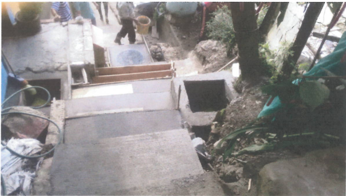
ESCALONES Y CÁMARA CON TAPA METÁLICA - DOMICILIARIAS
