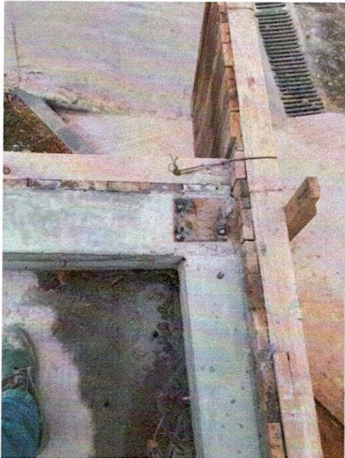
FOTO 11. Anclaje para pasamanos.
