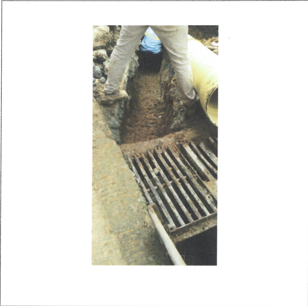
Sumidero carrera 11 entre 5 y 6 - Aguadas
