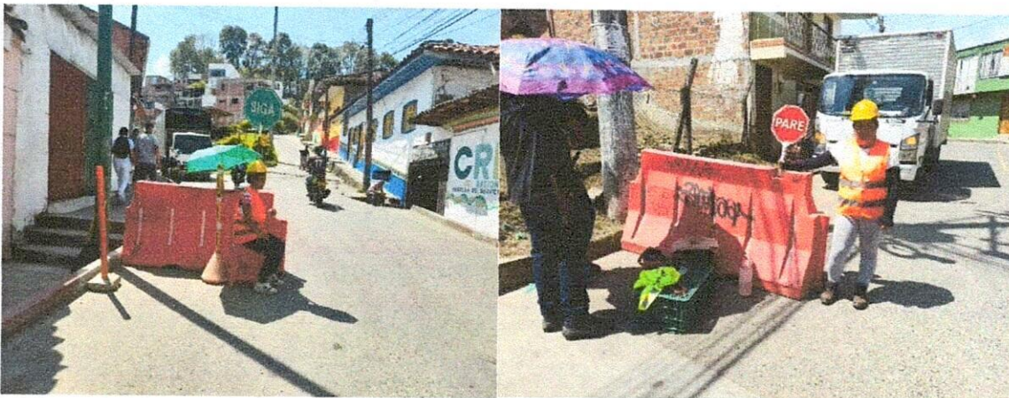
Fotos No. 2-3: Controladores de tránsito
