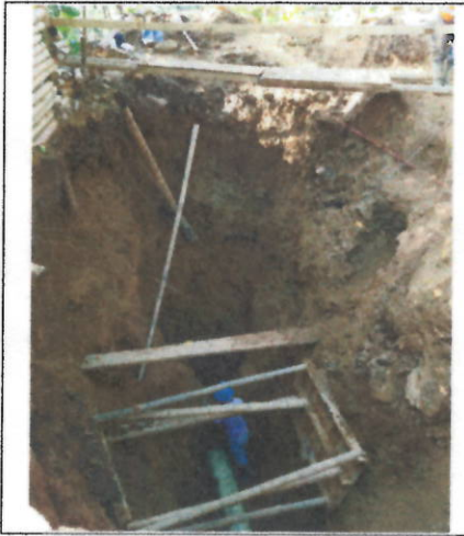
Excavación al 100% entre cámaras C33 y C32b con alturas promedio de 5,65m y anchos de hasta 4,10m, e instalación de tubería de dicho tramo.
