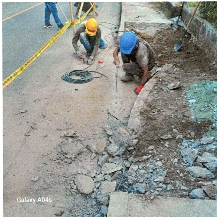
Imagen 16.- Demolición de estructuras en concreto en andén de vía principal, sector Cielito Lindo.
