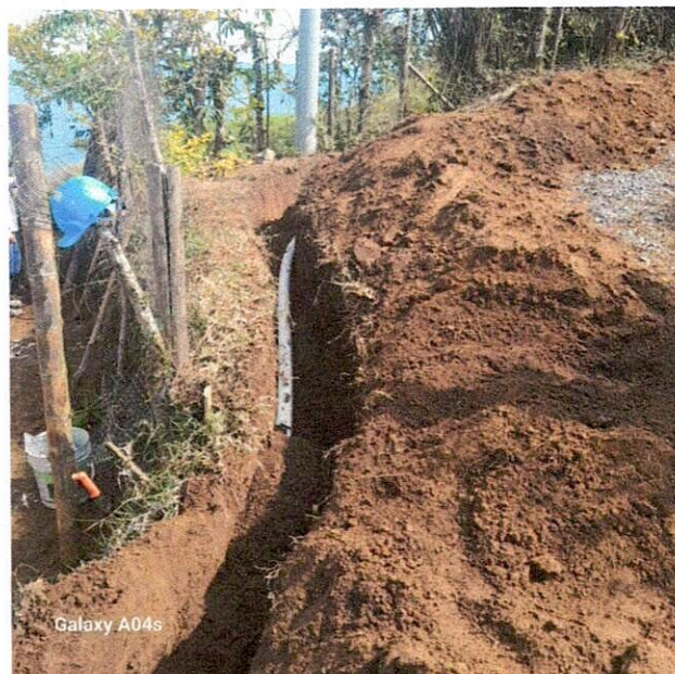
Imagen 2.- Inicio de excavación en zanja para posterior instalación de tubería de acueducto
