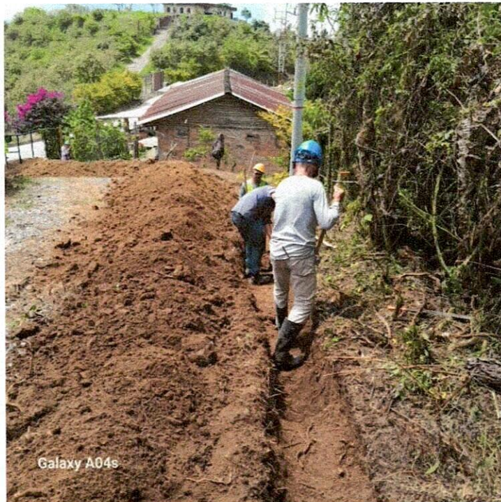
Imagen 4.- Inicio de excavación en zanja para posterior instalación de tubería de acueducto
