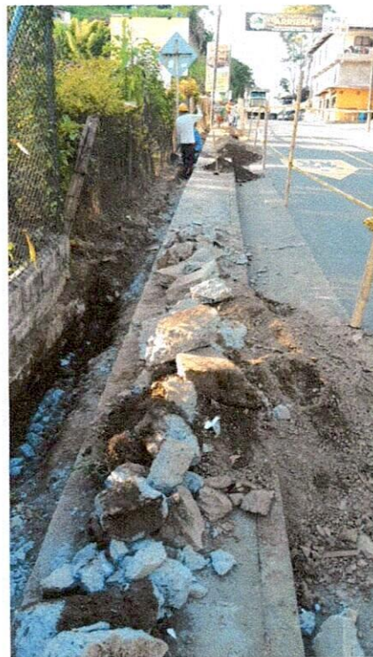
Imagen 14.- Demolición de estructuras en concreto en andén de vía principal, sector Cielito Lindo
