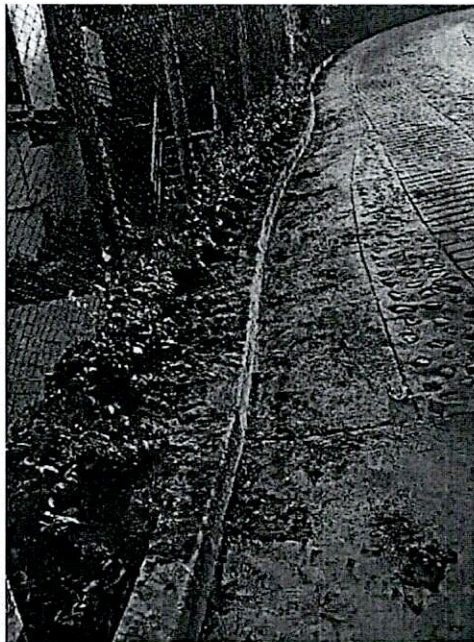
Excavación en zanja adyacente a placa huella en sector de Cielito Lindo para posterior instalación de tubería de acueducto
