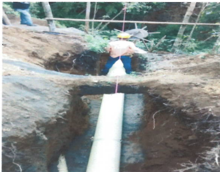
Transporte e Instalación Tubería PVC Corrugada de 315 mm (12") para Alcantarillado. Incluye sobre acarreo en vehículo y al hombro o mula.
