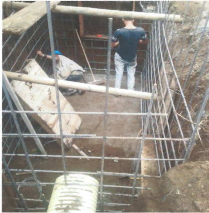
Suministro, Transporte e Instalación de Acero de Refuerzo de 1/4" a 1-1/4" de 420 Mpa (4200 Kg/cm 2 ). Incluye sobre acarreo en vehículo y al hombro o mula.
