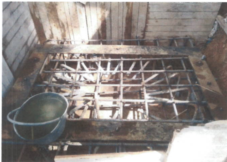
Suministro, Transporte e Instalación de Acero de Refuerzo de 1/4" a 1-1/4" de 420 Mpa (4200 Kg/cm 2 ). Incluye sobre acarreo en vehículo y al hombro o mula.
