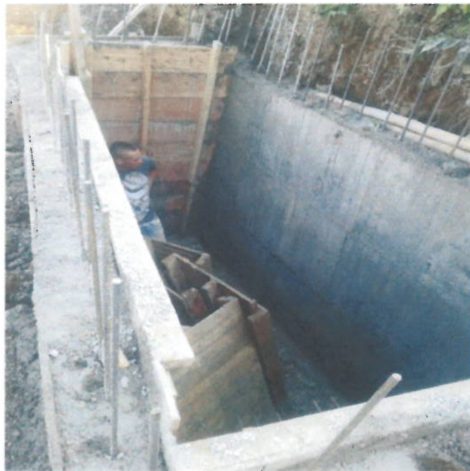
Concreto de 3000 psi (21 Mpa) Impermeabilizado para Aliviadero Tipo Vertedero Lateral. Incluye suministro, transporte e instalación de formaleta. Incluye sobre acarreo en
