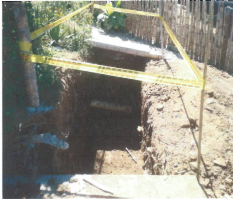
Suministro, transporte e instalación barrera con bombones plásticos, cinta de seguridad y yute para cerramiento .
