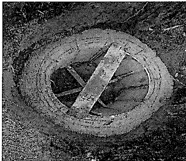
Suministro, Transporte e Instalación Cámara Circular de Inspección/Caída D=1.20 m. en Concreto Clase II. e=0,25m.
