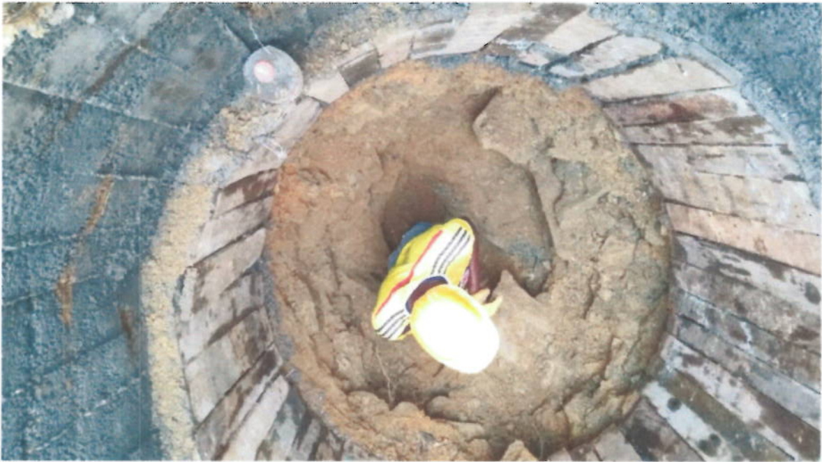
Construcción de caisson d=1.5 m para apoyo de viaducto de 32 m, excavaciones en material rocoso.
