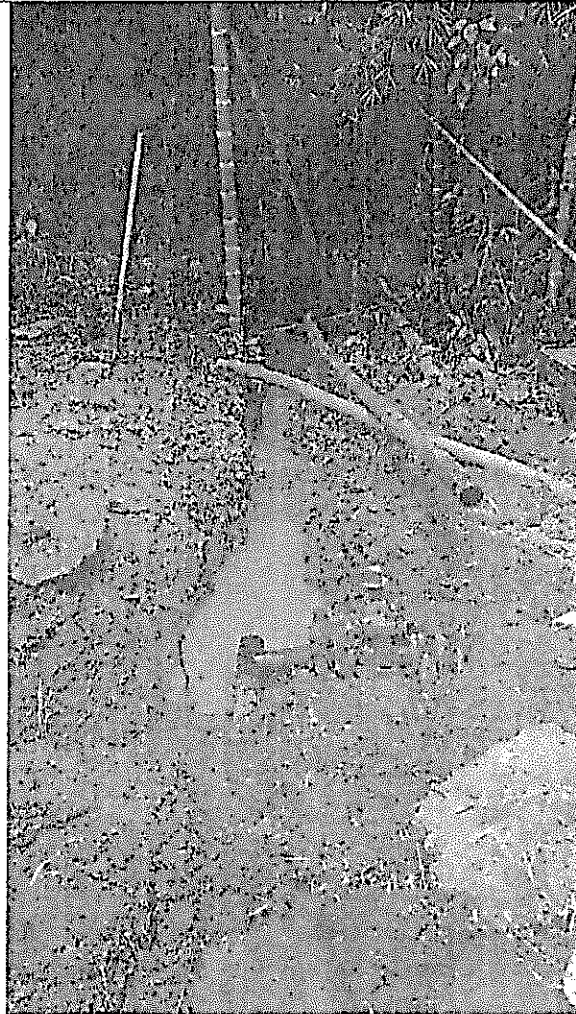
Daño de la tubería de polietileno
