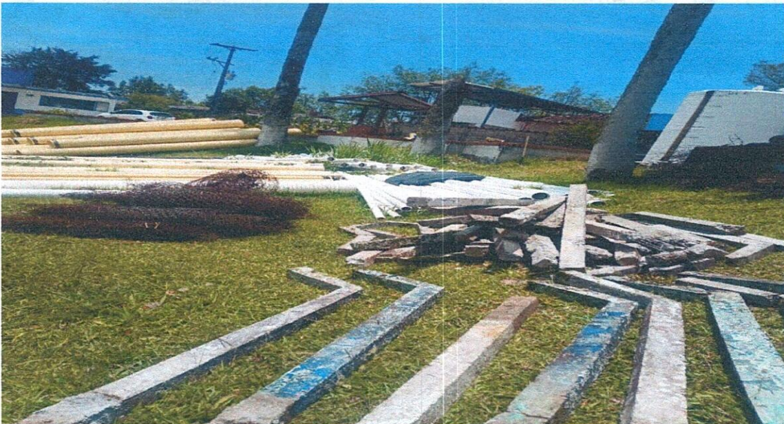
RETIRO DE SOBRES
