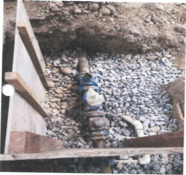
PISO DE CAJA PARA MACROMEDIDOR EN GRAVILLA
