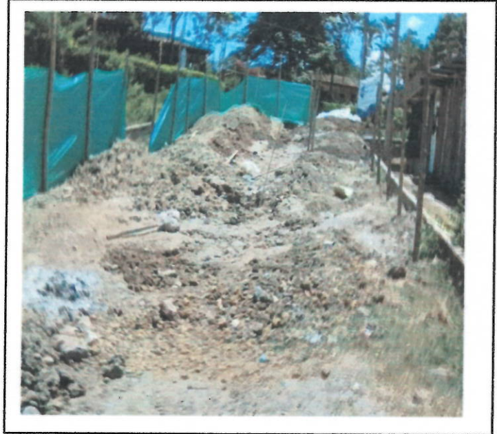
MATERIAL EN MAL ESTADO PRODUCTO DE LA EXCAVACION
