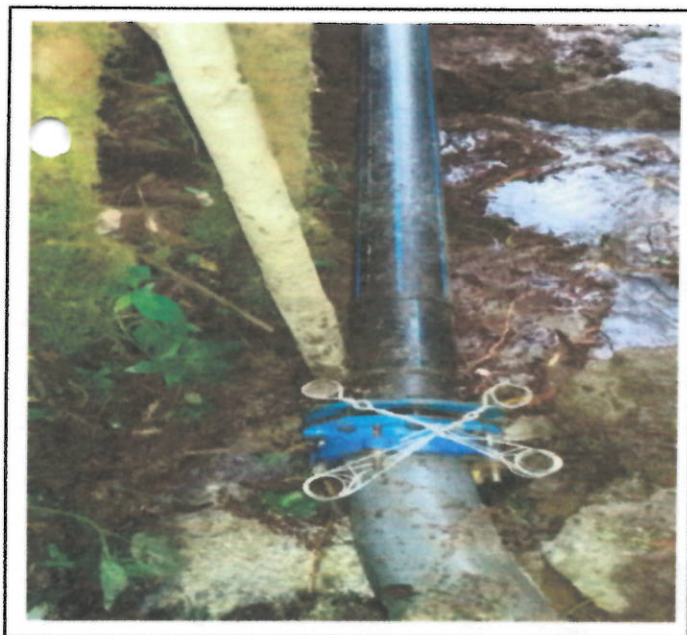
CONEXIÓN PVC A TUBERIA PF - BRIDA LOCA Y PORTAFLANCHES
