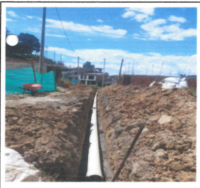
TUBERÍA PVC TIPO UNIÓN MECÁNICA DE 6" P/ ACUADUCTO
