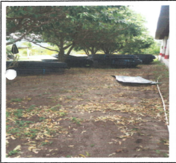
ROLLOS DE MANGUERA PF A INSTALAR
