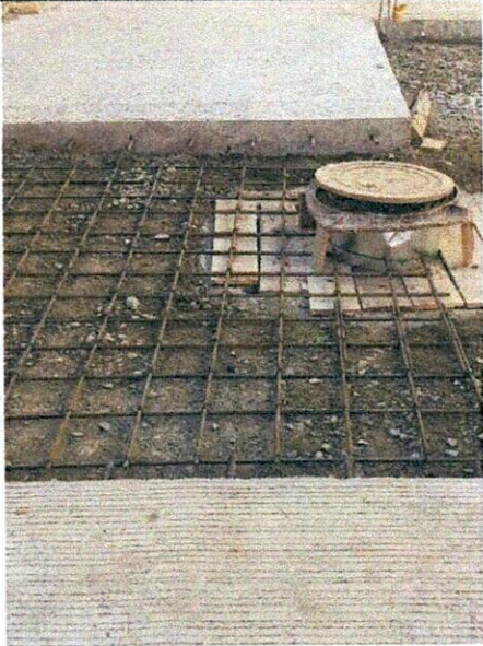
FOTO 15. Instalación de cámara
