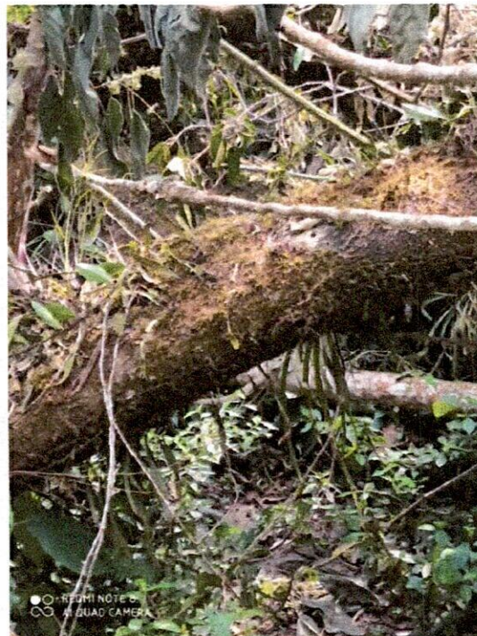
Imagen 22.- Corte de árboles caídos que interferían con la ruta de instalación de la tubería.
