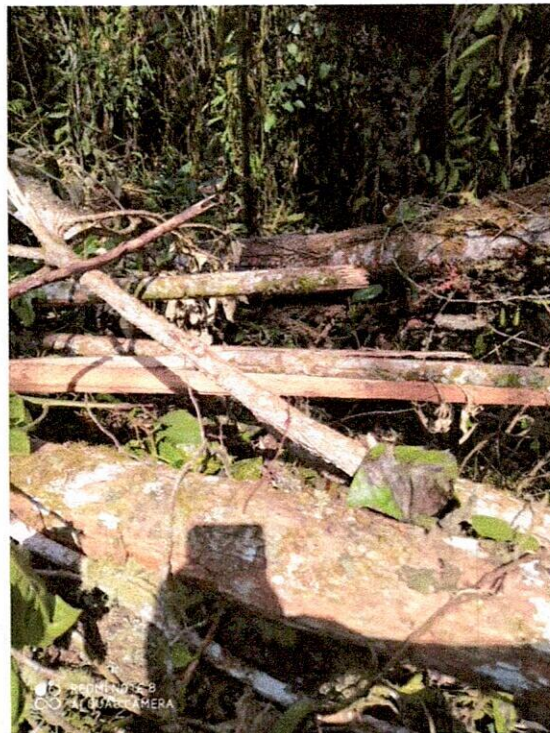
Imagen 18.- Corte de árboles caídos que interferían con la ruta de instalación de la tubería
