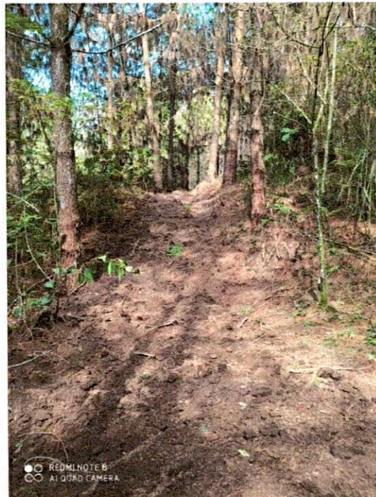
Imagen 24.- Rellenos compactos con material seleccionado de excavación posterior a instalación de tubería de polietileno de 10”.
