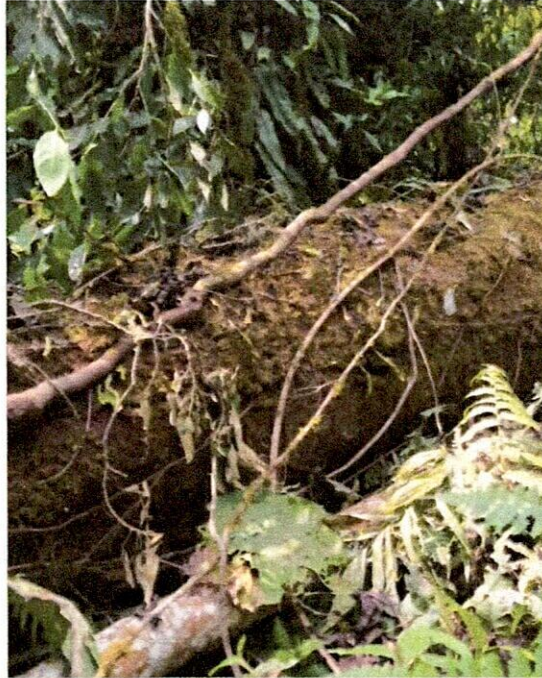
Corte de árboles caídos encontrados en el trayecto de instalación de tubería
