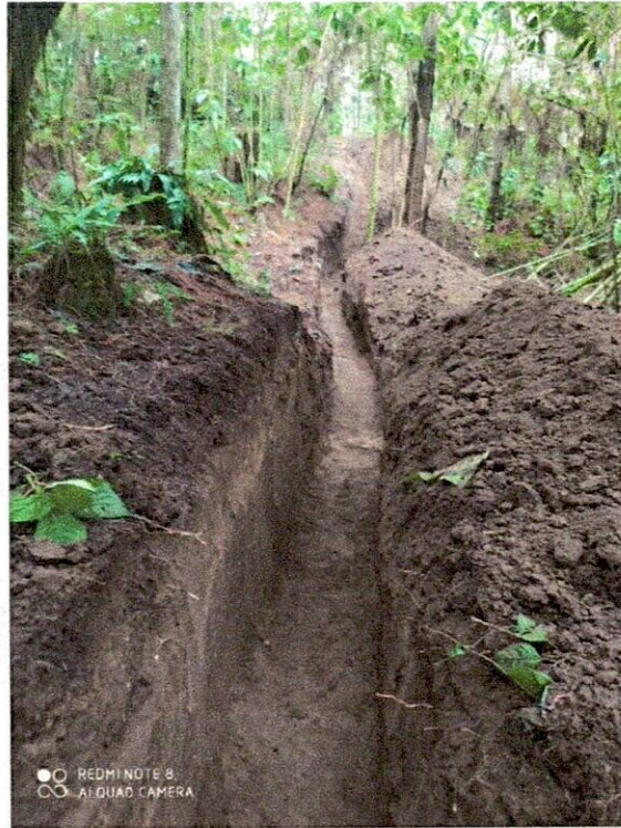
Imagen 5.- Excavación en zanja en material común para instalación de tubería de polietileno de 10"
