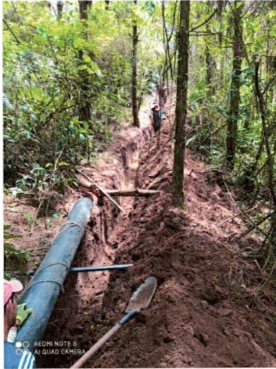
Imagen 13.- Excavación en zanja en material común para instalación de tubería de polietileno de 10"
