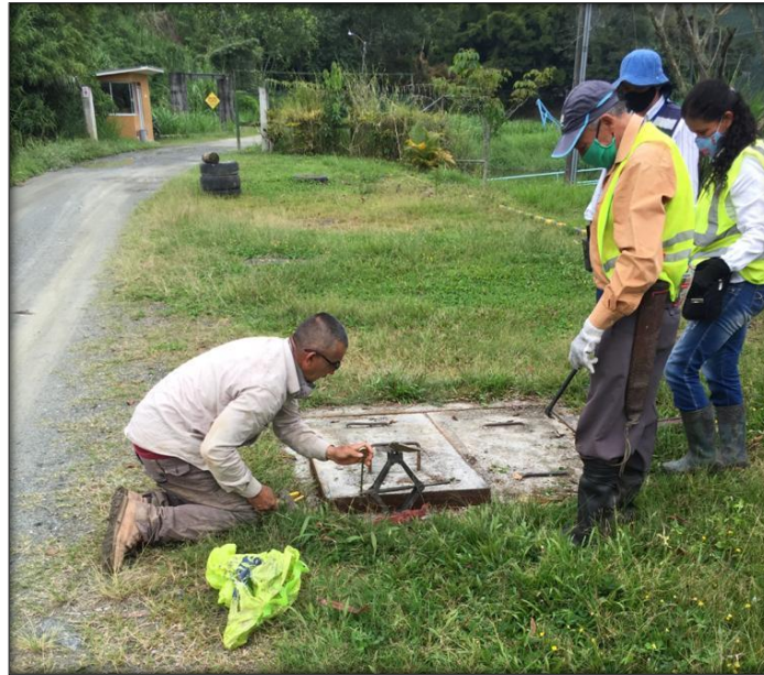
Figura 10. Cámara de inspección de empalme aguas abajo.
