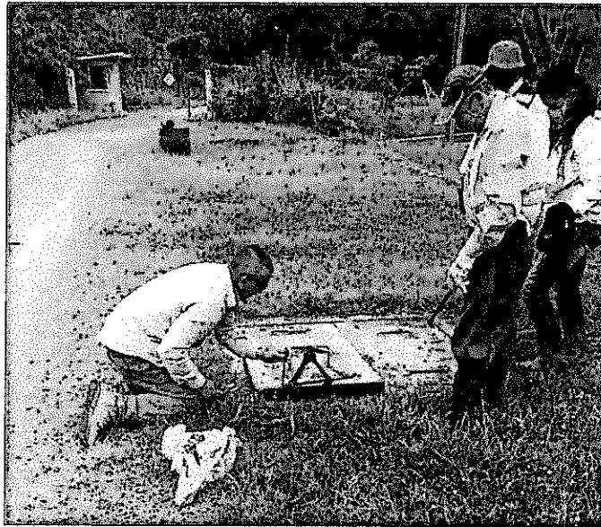
Figura 10. Cámara de inspección de empalme aguas abajo.
