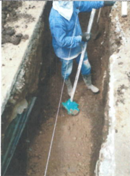
Imagen 15 Calle 3 entre carrera 2 y 3 (13 nov – 2019)
