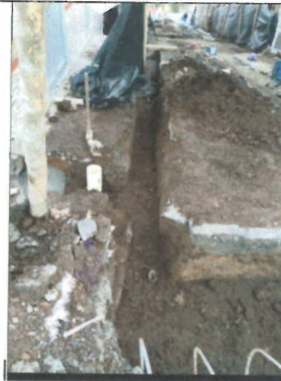
Imagen 25 Calle 18 entre carrera 1 y 2 (14 nov – 2019)
