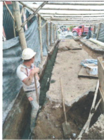
Imagen 12 Calle 18 entre carrera 1 y 2 (06 nov – 2019)
