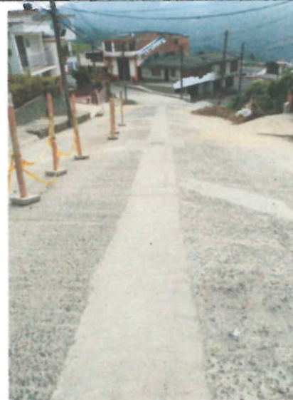
Imagen 4 Calle 24 entre carreras 3 y 4 (27 Nov – 2019)
