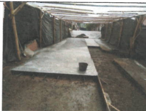
imagen 27 Calle 18 entre carrera 1 y 2 (21 nov – 2019)
