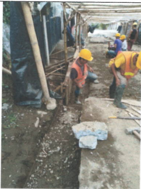
Imagen 26 Calle 18 entre carrera 1 y 2 (19 nov – 2019)
