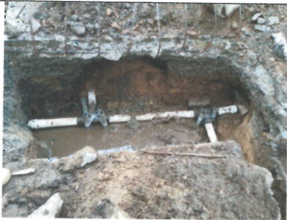
Imagen 24 Calle 18 entre carrera 1 y 2 (14 nov – 2019)
