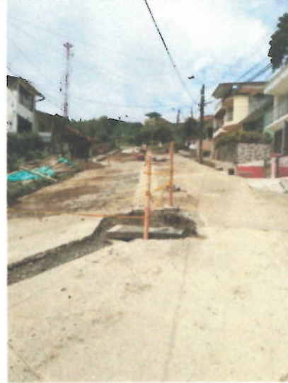
Imagen 2 Calle 24 entre carreras 3 y 4 (06 nov – 2019)
