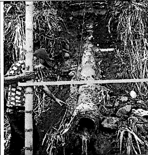
TUBERÍA ANTIGUA EN MAL ESTADO
