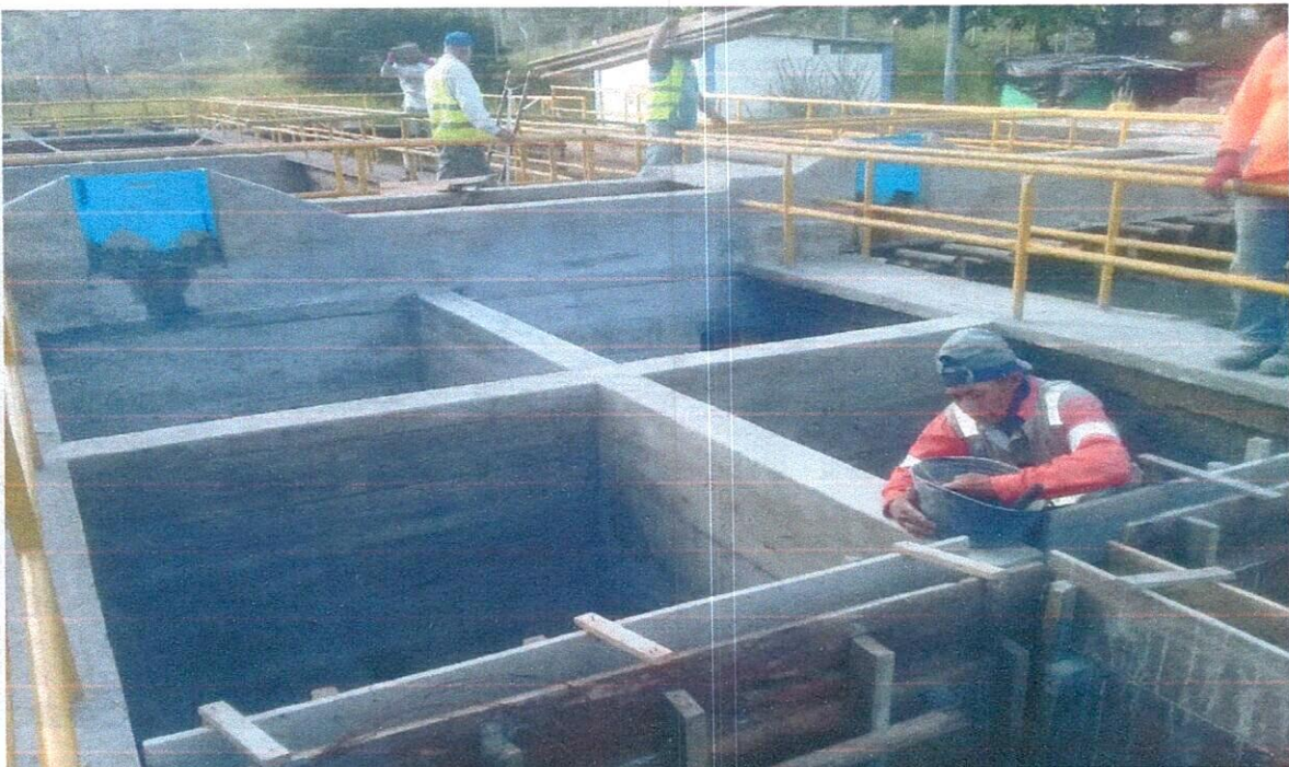
COMPUERTA DE INGRESO A FLOCULADORES
