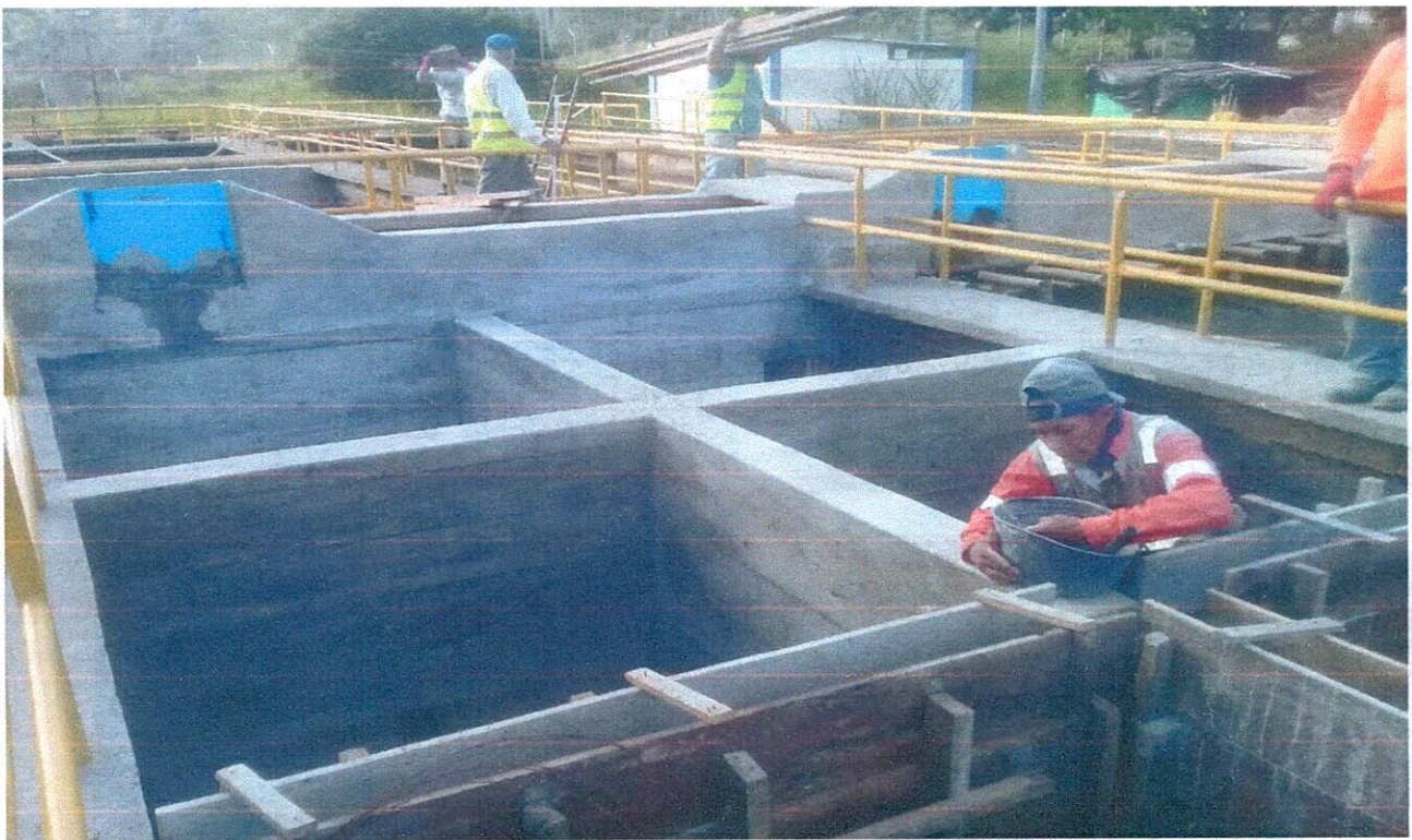
COMPUERTA DE INGRESO A FLOCULADORES
