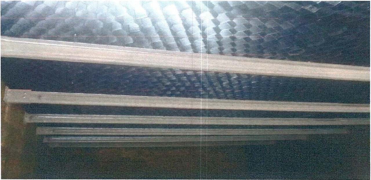
SOPORTES PARA MÓDULOS DE SEDIMENTACIÓN
