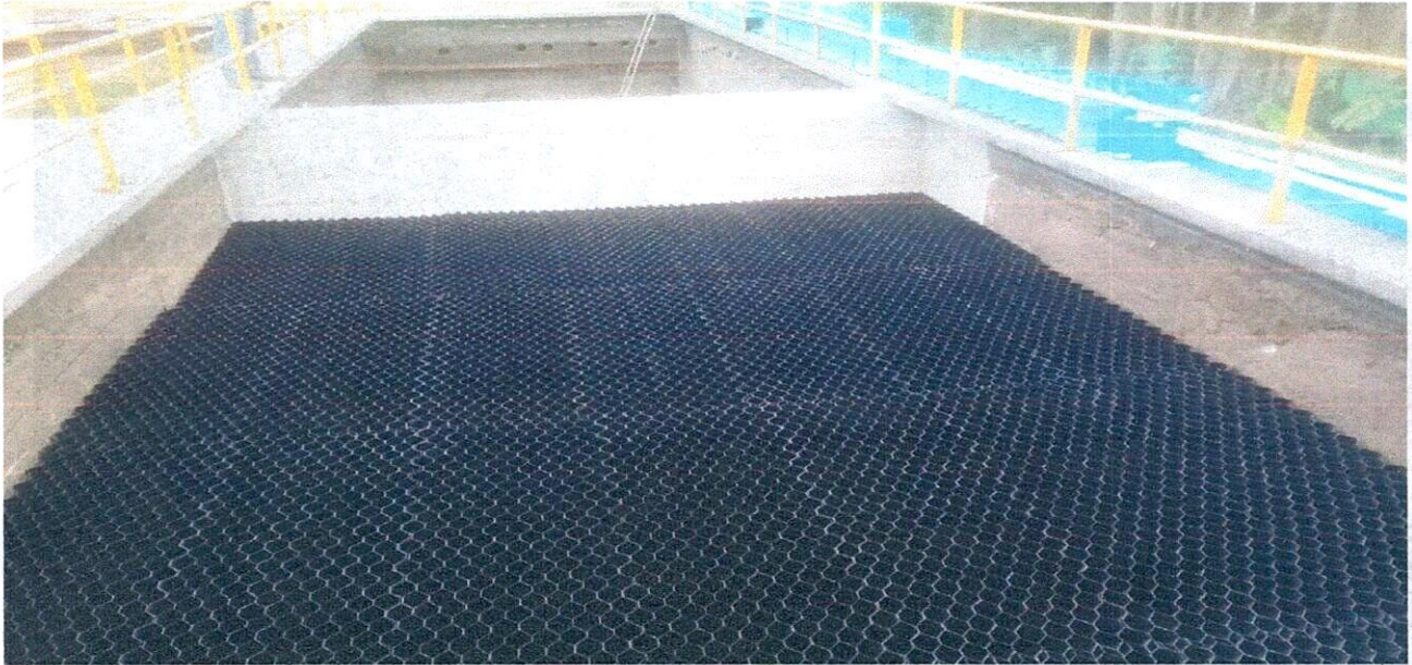
MÓDULOS DE SEDIMENTACION 2
