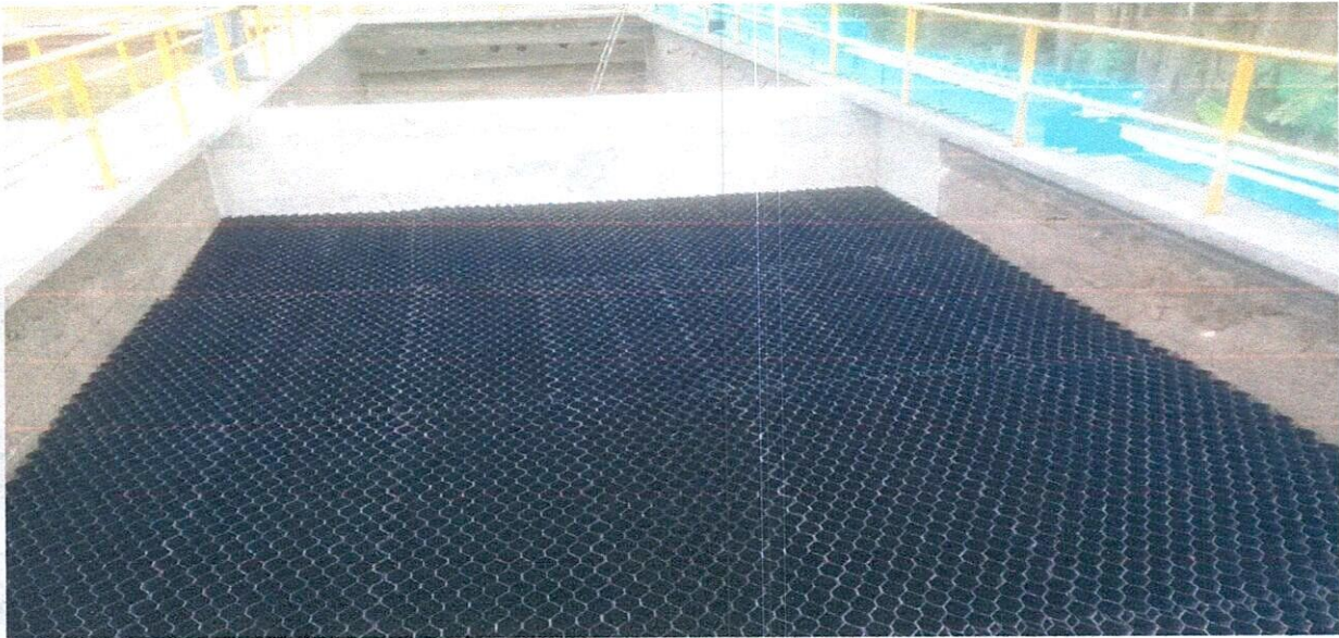
MÓDULOS DE SEDIMENTACION 2
