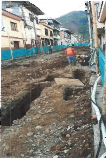
Imagen 19 Carrera 9 entre calle 7 y calle 8 ( 02 oct – 2019)
