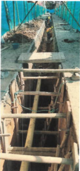
Imagen 7 Calle 4A entre carrera 8 y 9 (28 sept – 2019)
