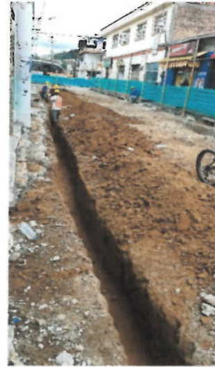
Imagen 28 Calle 13 entre Carrera 9 y Carrera 8 (05 oct – 2019)
