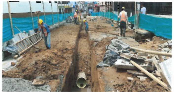
Imagen 24 Carrera 6 entre calle 8 y calle 9 (17 oct – 2019)
