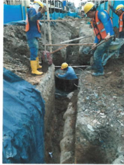
Imagen 2 Calle 4A entre carrera 8 y 9 (12 sept – 2019)
