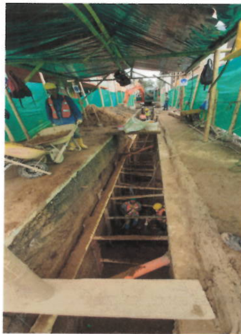
Imagen 8 Calle 4A entre carrera 8 y 9 (17 oct – 2019)
