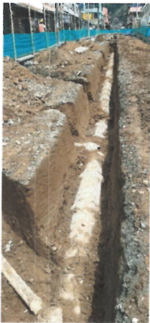
Imagen 23 Carrera 6 entre calle 8 y calle 9 (01 oct – 2019)
