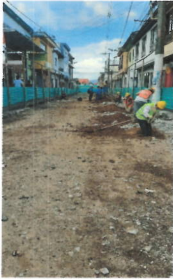
Imagen 27 Calle 13 entre Carrera 9 y Carrera 8 (03 oct – 2019)
