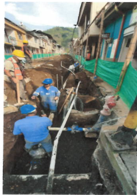
Imagen 20 Carrera 9 entre calle 7 y calle 8 ( 17 oct – 2019)
