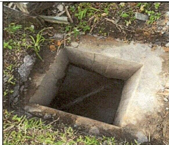
FOTO 10. Caja de inspección domiciliaria de 0,50m x 0,50m.
