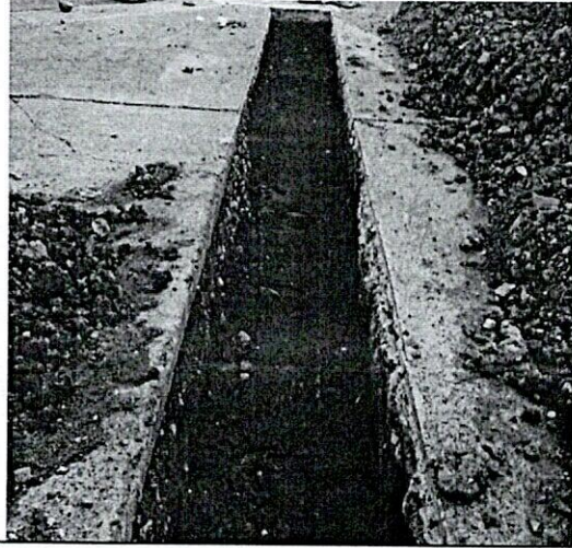
FOTO 5. Tramo desde la cámara con material orgánico para sustituir
