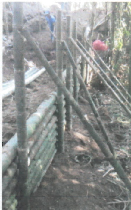
Fotos 14. Trinchos C-7 y C-8
