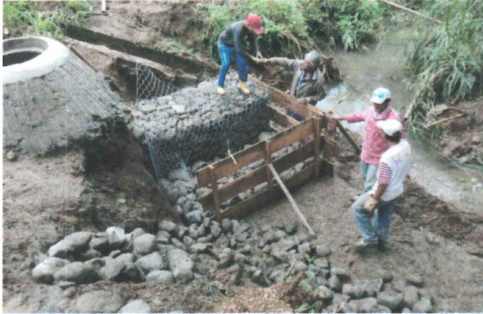
Fotos 11. Gaviones protegiendo la socavación de la C-2
