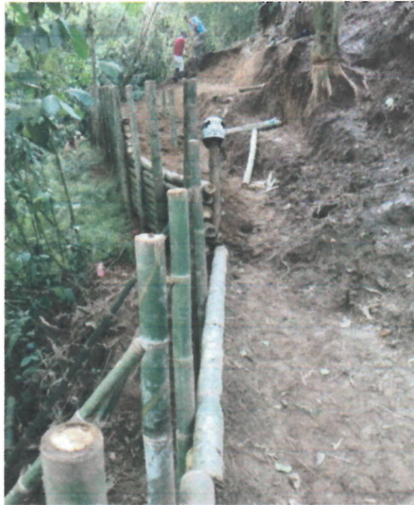
Fotos 15. Trinchos C-6 y C-7
