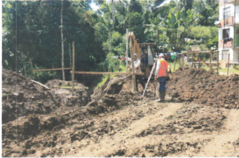
Foto 9. Comisión de topografía para la instalación de la tubería debido a las bajas pendientes
