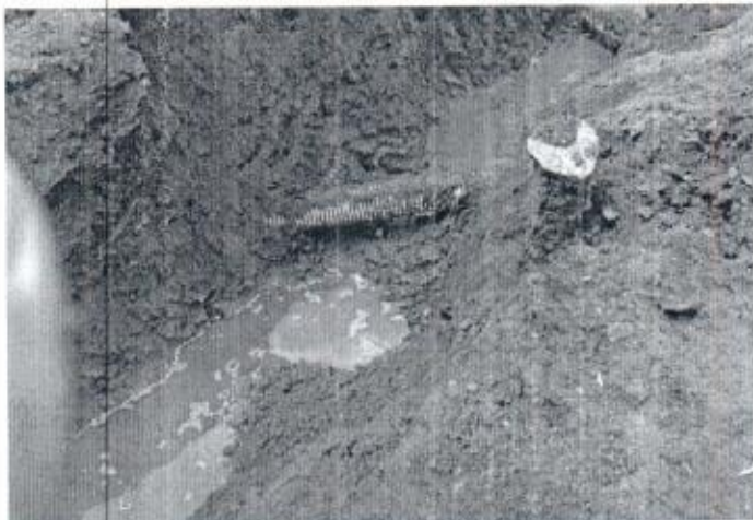
Fotos 17. Presencia de filtros
