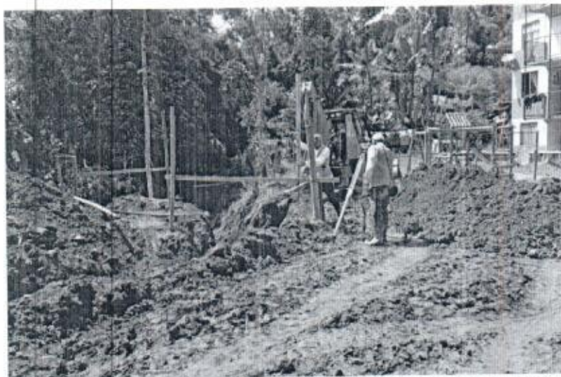
Foto 12. Comisión de topografía para la instalación de la tubería debido a las bajas pendientes
