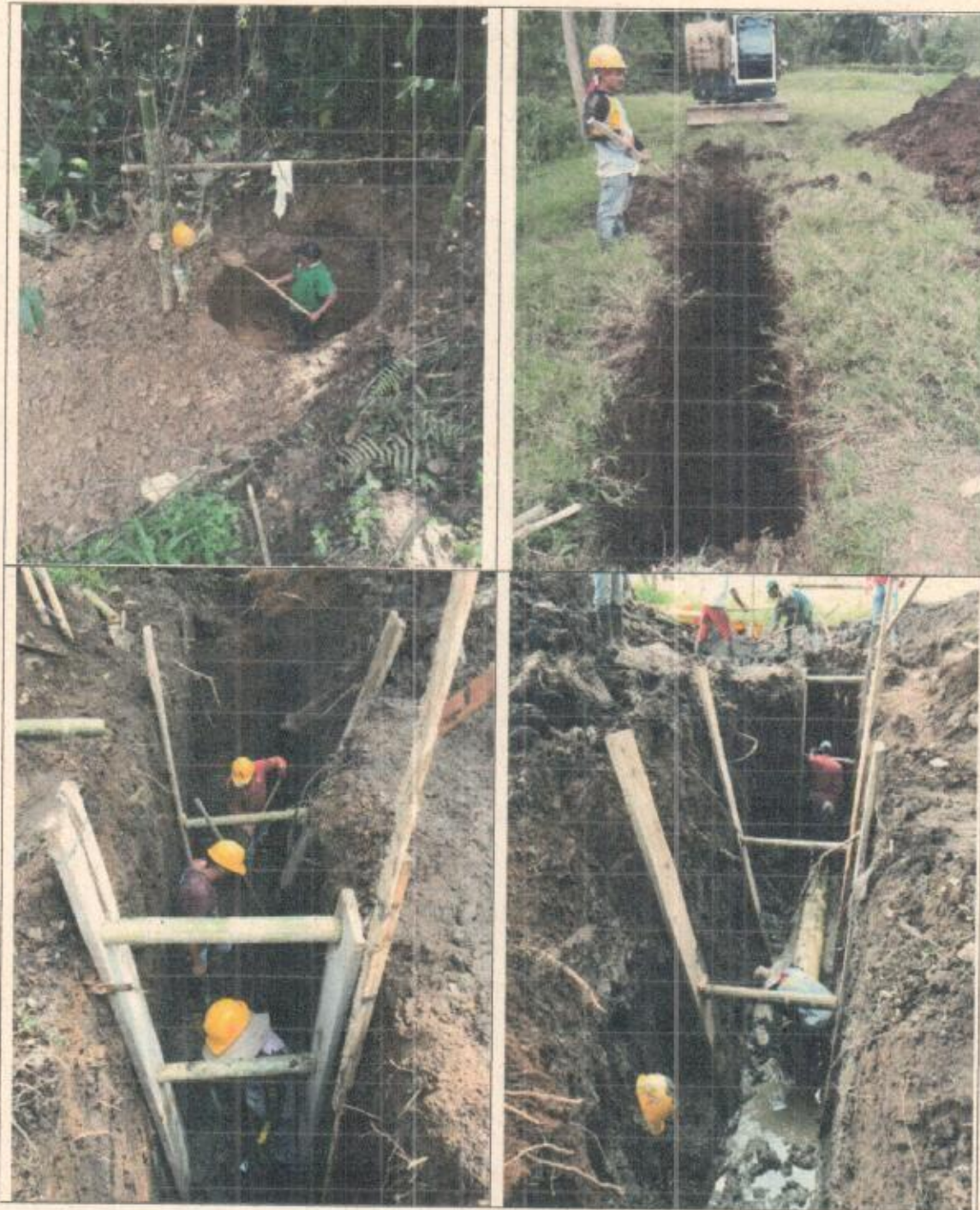
Para el proceso de excavación se realizó con retroexcavadora y se realizaba entibado cada 6 metros para la instalación del tubo de 12".
