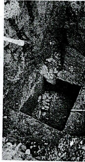
FOTO 14. Empalme de caja domiciliaria.
