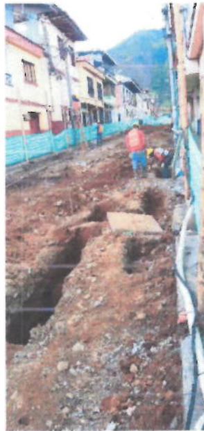
Imagen 19 Carrera 9 entre calle 7 y calle 8 (02 oct – 2019)
