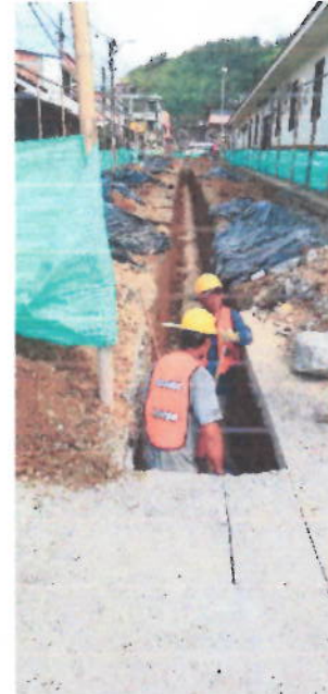
Imagen 24 Carrera 6 entre calle 8 y calle 9 (04 oct - 2019)
