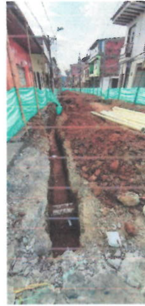
Imagen 20 Carrera 9 entre calle 7 y calle 8 (05 oct – 2019)
