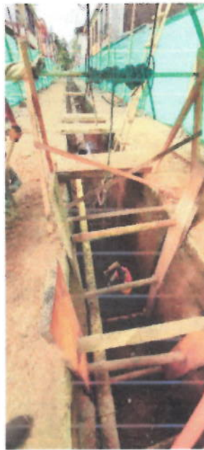
Imagen 8 Calle 4A entre carrera 8 y 9 (04 oct - 2019)
