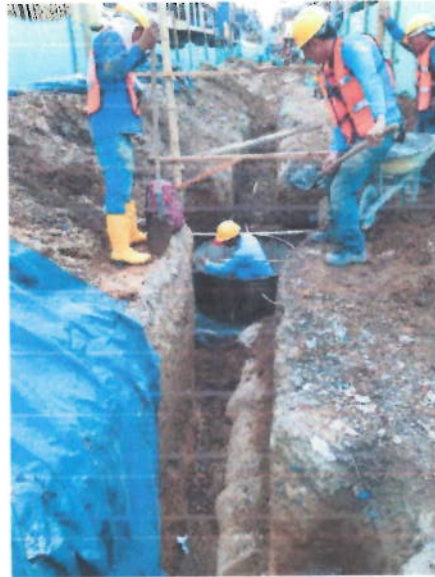
Imagen 2 Calle 4A entre carrera 8 y 9 (12 sept – 2019)
