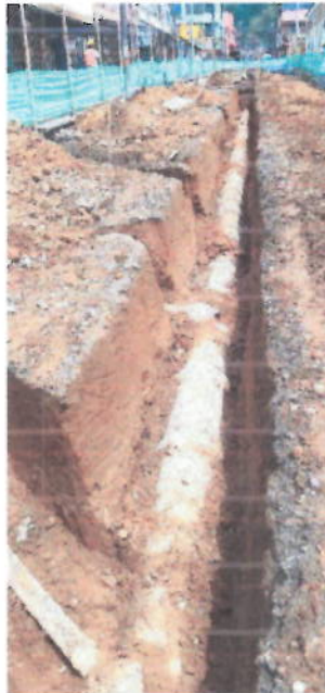
Imagen 23 Carrera 6 entre calle 8 y calle 9 (01 oct - 2019)
