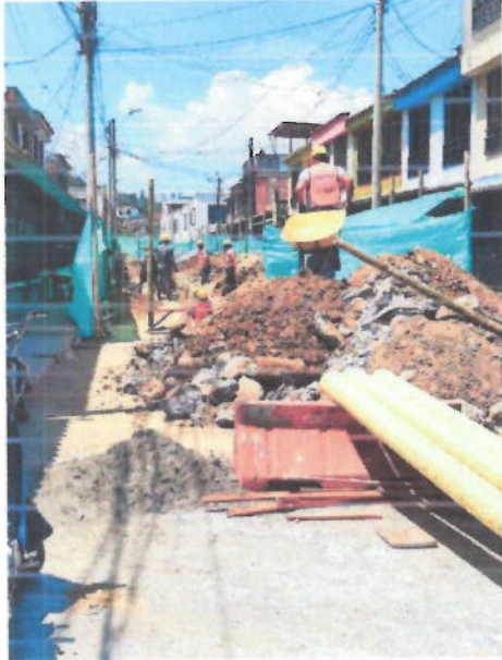
Imagen 1 Calle 4A entre carrera 8 y 9 (10 sept – 2019)
