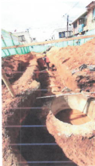
Imagen 3 Calle 4A entre carrera 8 y 9 (24 sept – 2019)
