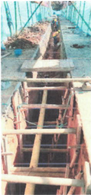
Imagen 7 Calle 4A entre carrera 8 y 9 (28 sept - 2019)
