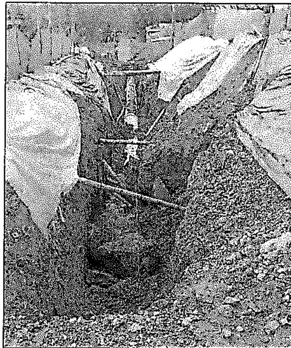
(contingencia por deslizamiento del talud)
