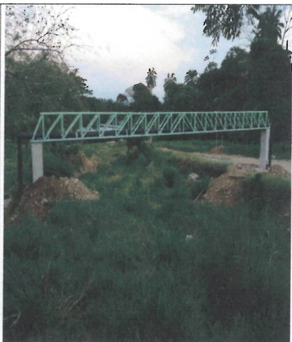
Tubería PN 8" sobre viaducto metálico
