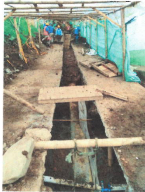
Imagen 8 Calle 3 entre carrera 2 y 3 (06 nov – 2019)
