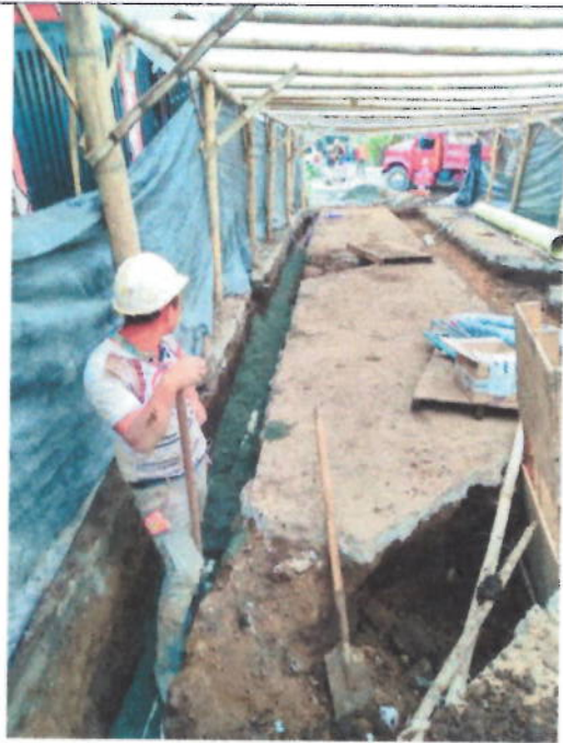
Imagen 4 Calle 18 entre carrera 1 y 2 (06 nov – 019)
