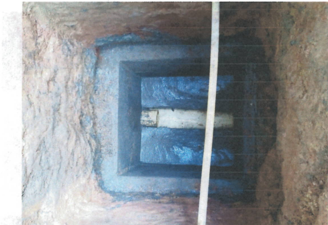
Caja de inspección domiciliaria con cañuela en pvc
