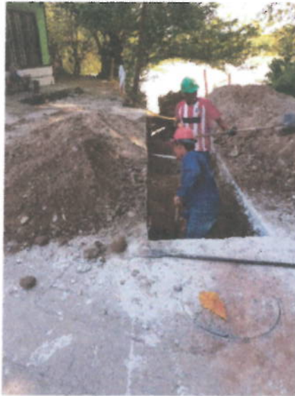
Fotografía No. 2. Los trabajadores usan los elementos de protección personal tipo 1 en todo momento que se encuentren realizando algún tipo de labor dentro de las obras.
