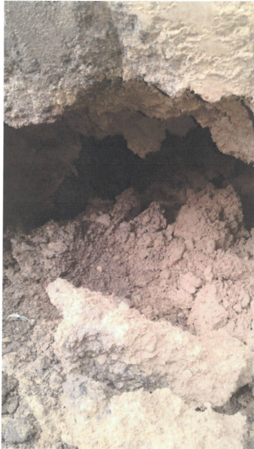
Cárcavas en sitios de la obra
