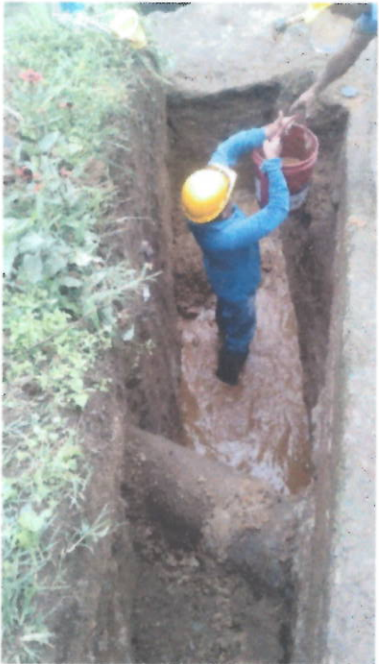
Lodo que fue necesario retirar después de lluvia
