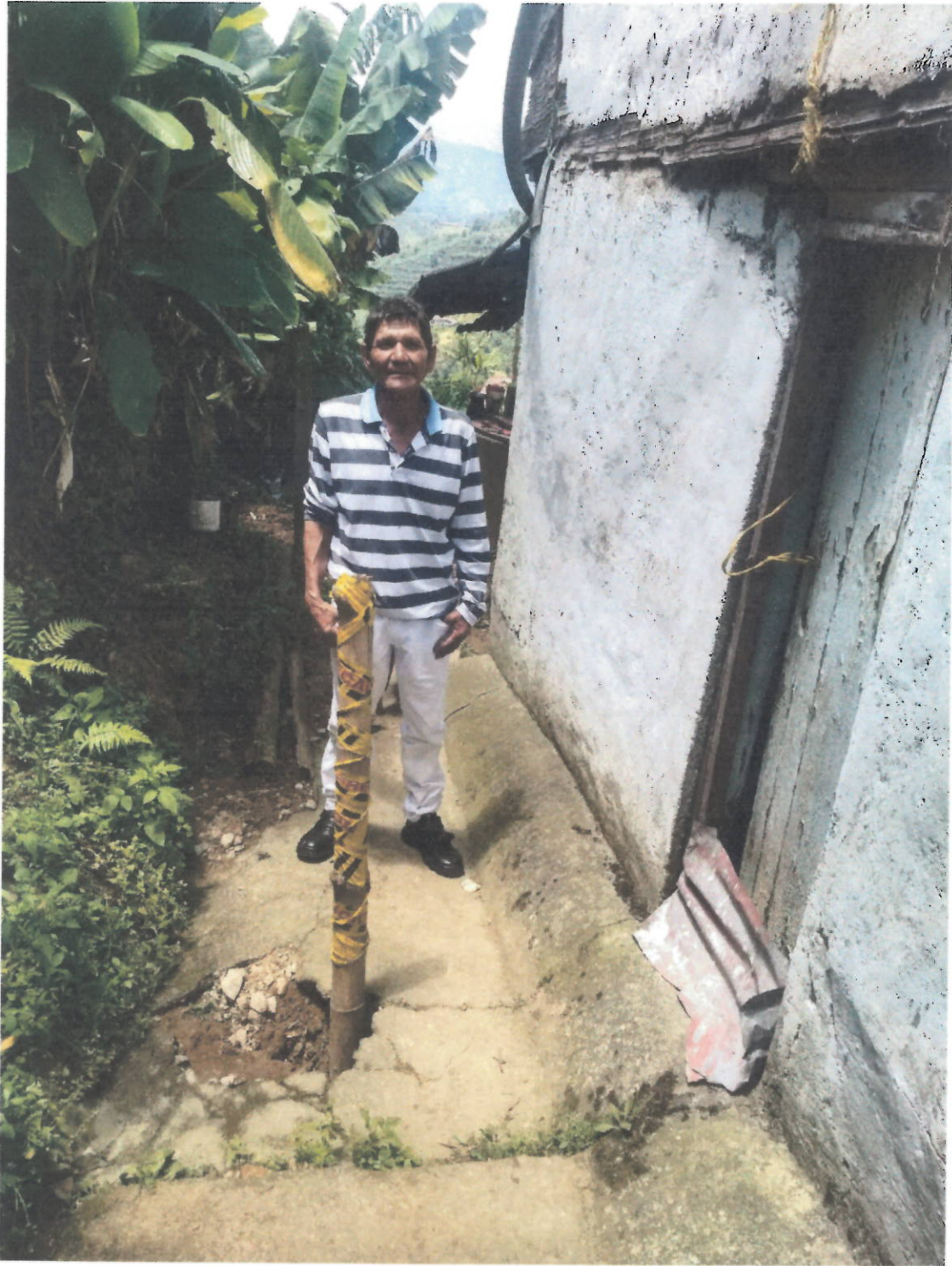
Propietario de vivienda con afectación posiblemente por las filtraciones que se han encontrado.
