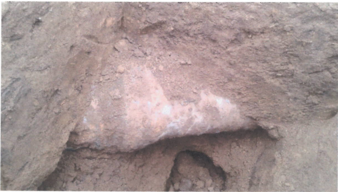
Cárcavas en sitios de la obra
