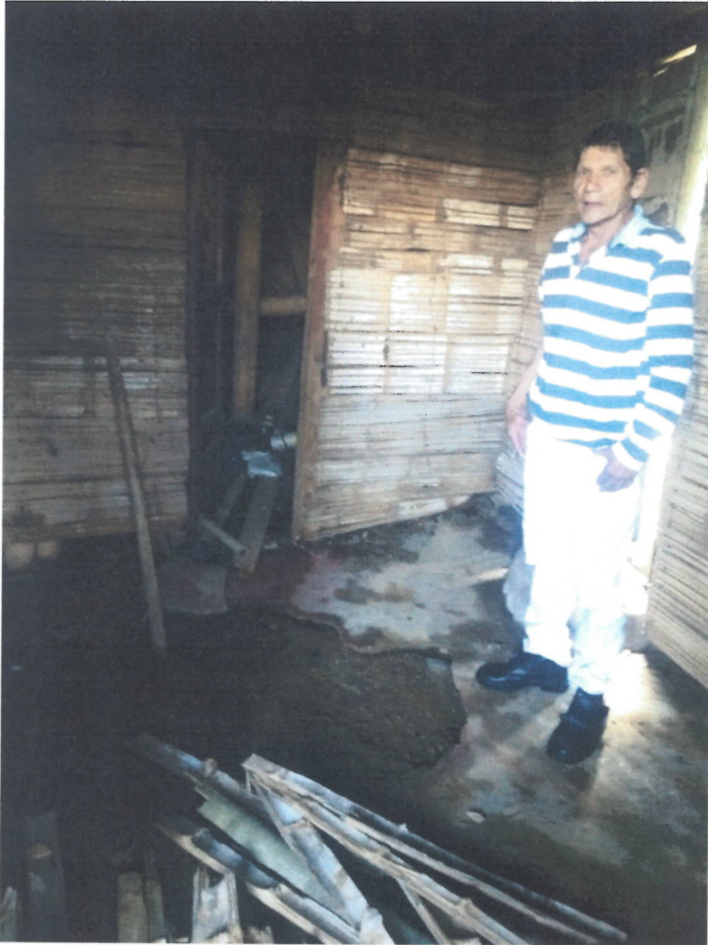
Vista donde se ve afectación en placa dentro de la vivienda.
