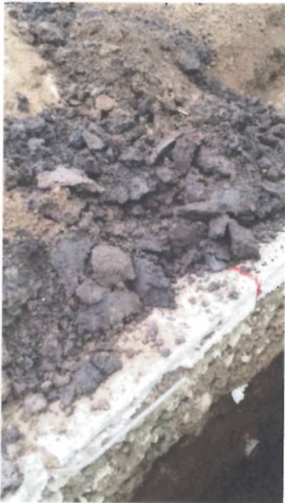
Marca de instalación de la silleta
