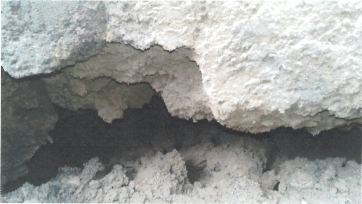
Cárcavas en sitios de la obra
