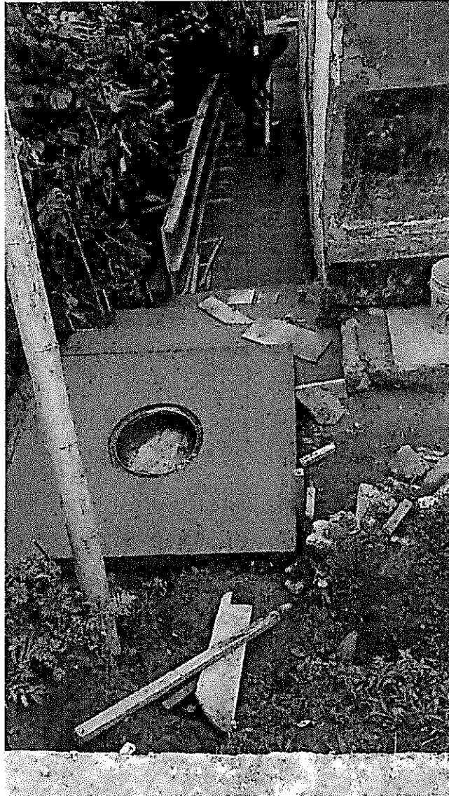
Izquierda Escalas agua abajo de la cámara B1 – Derecha callejón sobre la tubería de 24" cubierto en concreto para protección de la tubería
