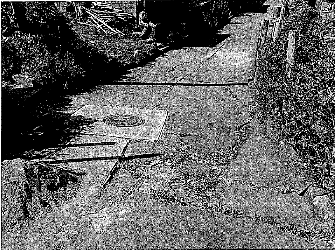
FORMACIÓN DE GRIETAS EN TRAZADO DE TUBERÍA EN CONCRETO
