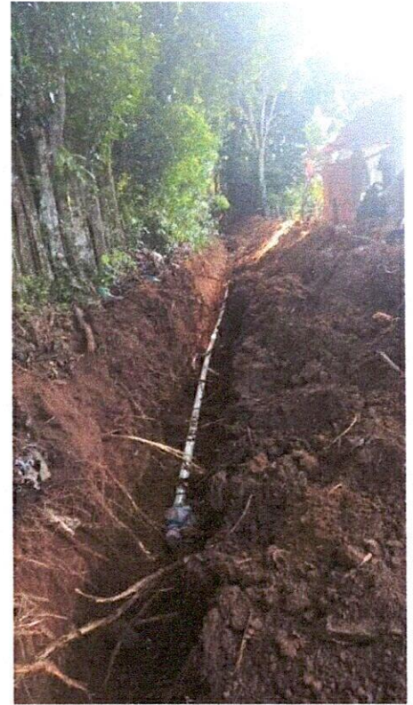
Fotografía No. 01 Evidencia de presencia de raíces y material orgánico
