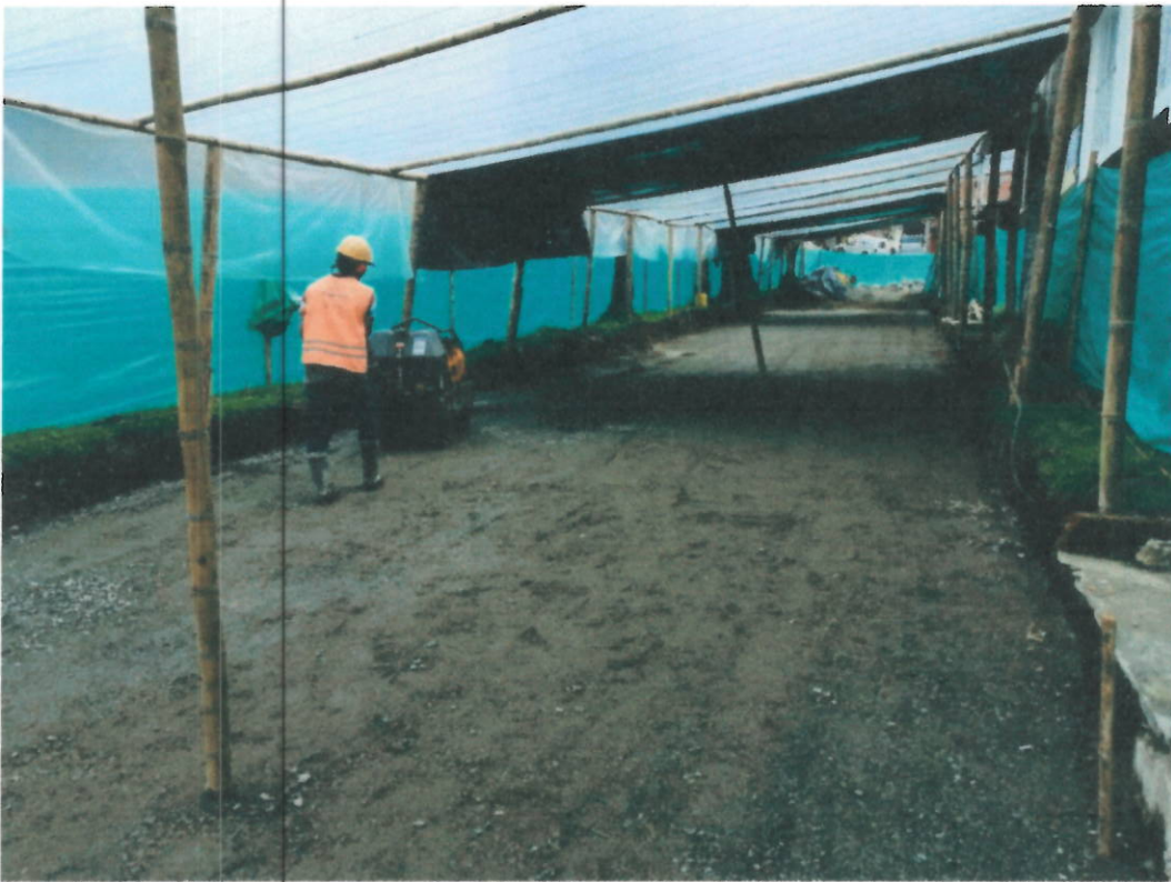
Foto 19 y 20. Rellenos compactados, Suministro e instalación de afirmado, subbase tipo Invias y material granular para tuberías
