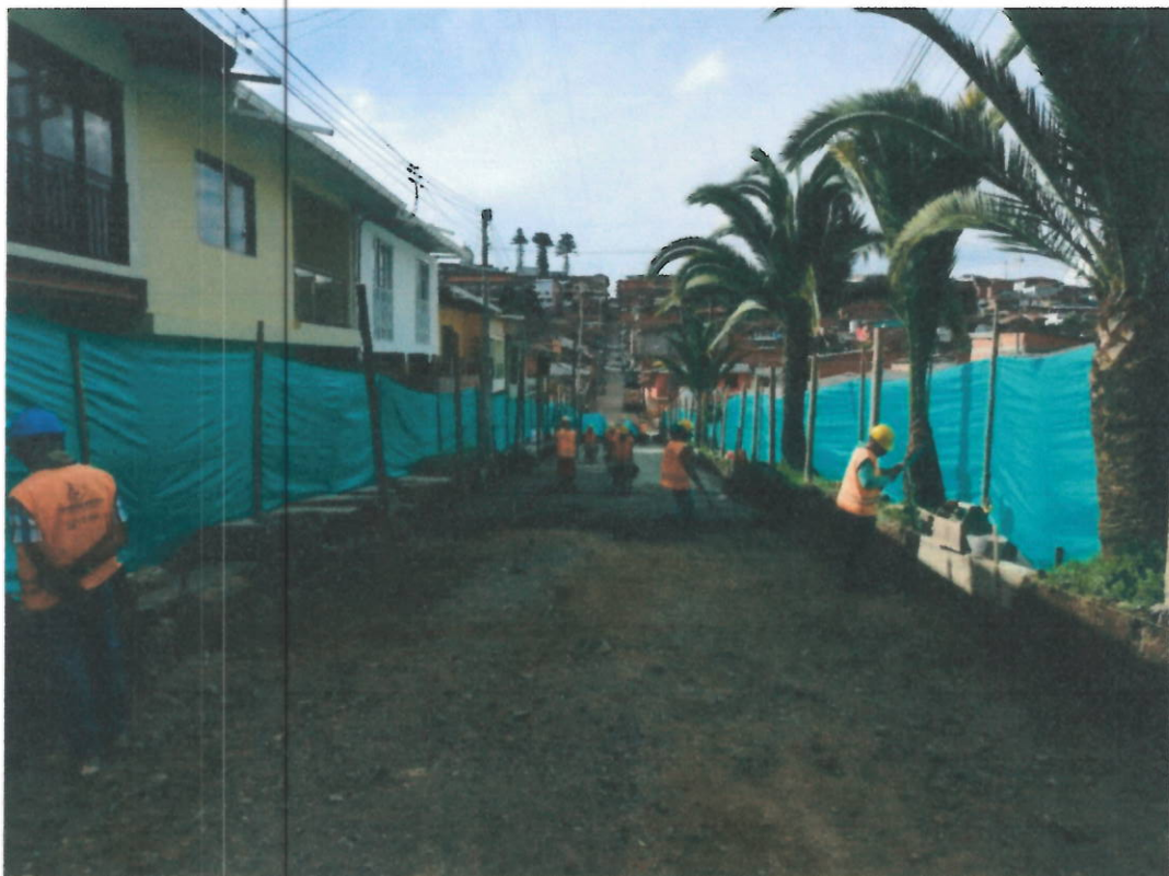
Foto 17 y 18. Rellenos compactados, Suministro e instalación de afirmado, subbase tipo Invias y material granular para tuberías
