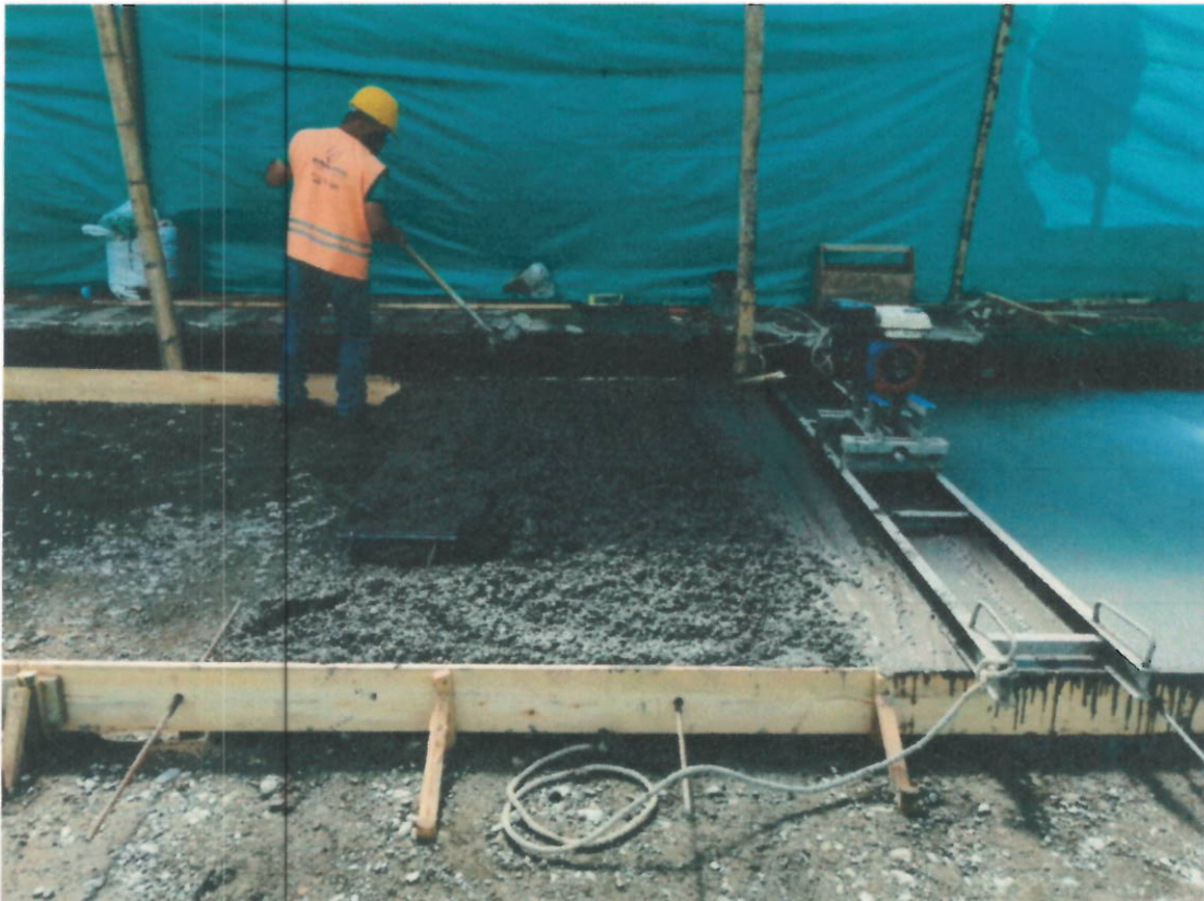
Foto 25 y 26. Acero para la conformación de Dovelas, Canastillas, Pavimento rígido de 4000 Psi y Acero de refuerzo para losas
