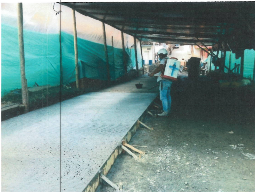
Foto 27 y 28. Acero para la conformación de Dovelas, Canastillas, Pavimento rígido de 4000 Psi y Acero de refuerzo para losas
