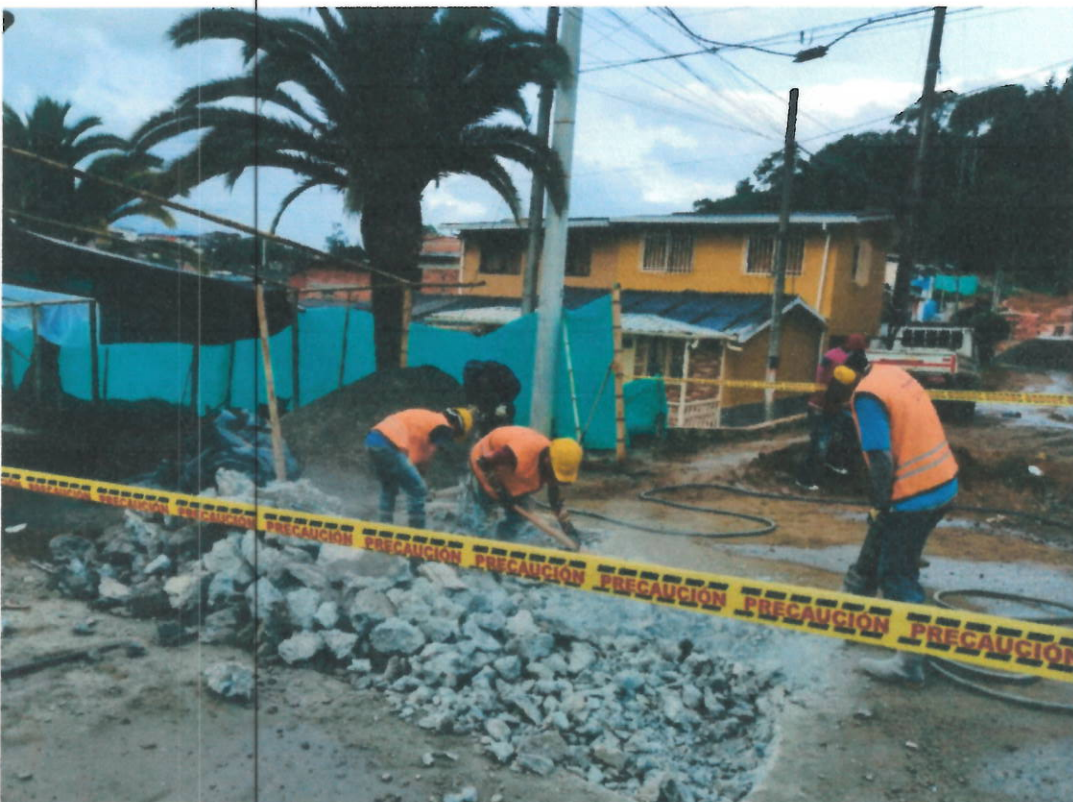
Foto 5 y 6. Corte de pavimento Rígido 3000 PSI y Demoliciones de pavimentos rígidos y andenes y sardineles
