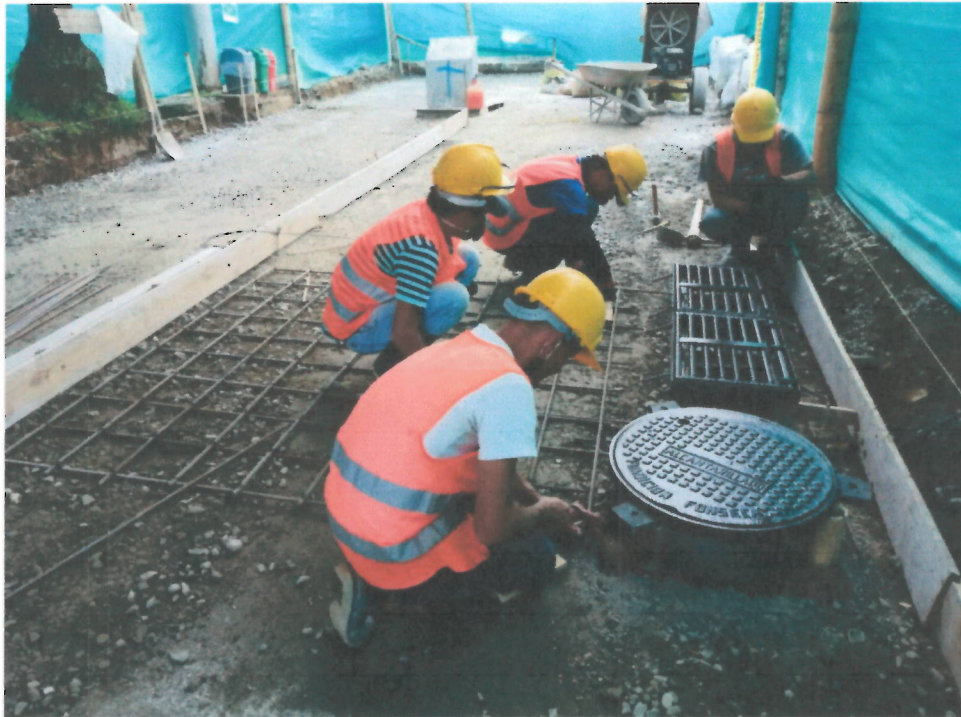
Foto 3 y 4. Acero para la conformación de Dovelas, Canastillas y Acero de refuerzo para losas y Sumidero doble reja tipo sifón en concreto
