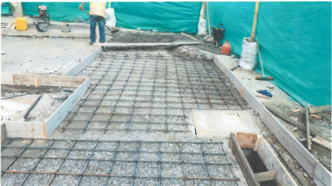
Foto 6, 7. Acero para la conformación de Dovelas, Canastillas y Acero de refuerzo para losas. Pavimento en rígido de 4000 Psi
