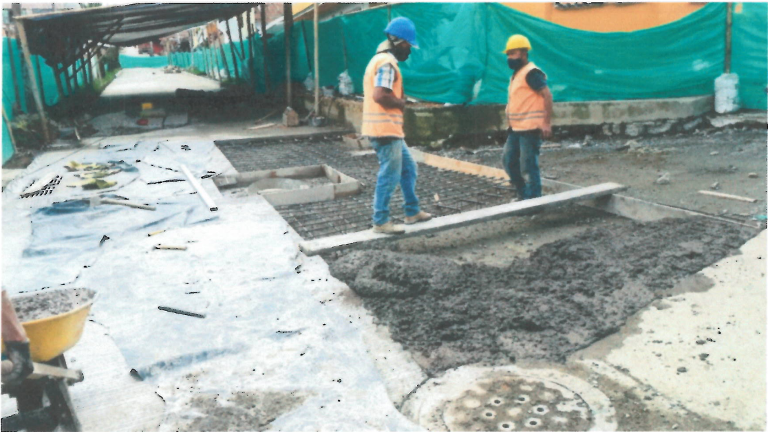
Foto 8, 9. Acero para la conformación de Dovelas, Canastillas y Acero de refuerzo para losas. Pavimento en rígido de 4000 Psi
