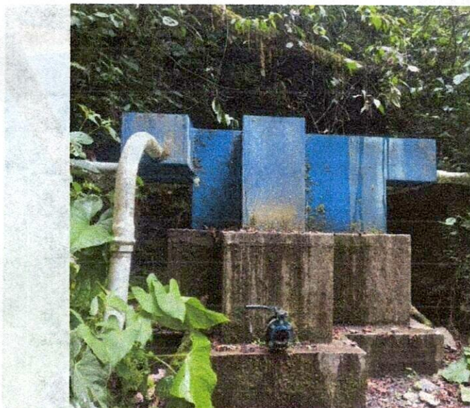
Ilustración 10: estado inicial del desarenador
