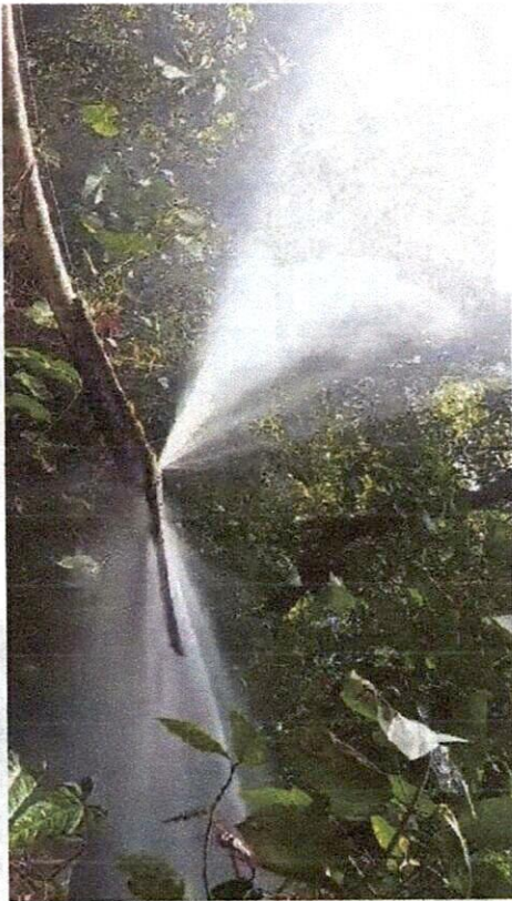
Ilustración 13: fuga en tubería
