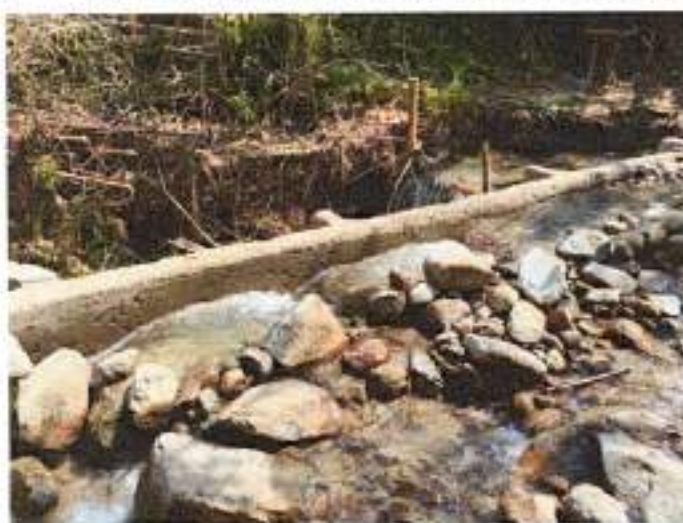
Figura 5. Colmatación en la zona de los desarenadores
