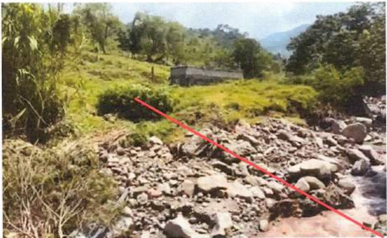
Figura 7. Tramo de tubería entre tanque y planta de tratamiento
