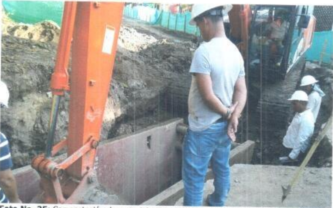
Foto No. 25: Compactación de material sobre primer tubo instalado cerca de la cámara 11.
