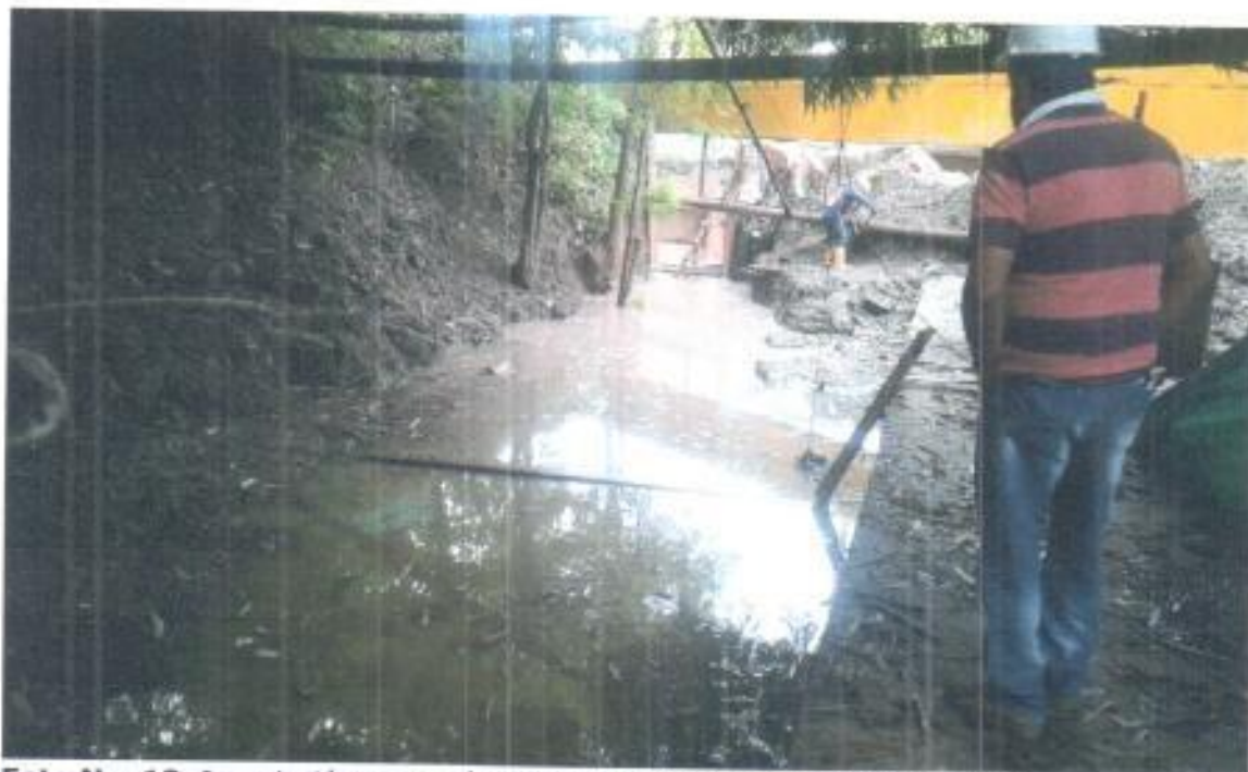
Foto No. 12: Inundación entre cámaras 11 y 12 debido constantes lluvias.
